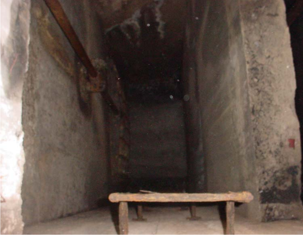
Fotos 1 y 2 Efectos de la corrosión y erosión en las lumberas en operación.
