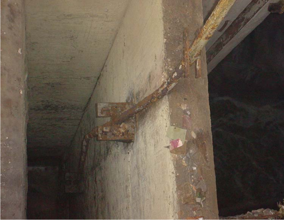
Foto 7 Daños en los mecanismos de operación
