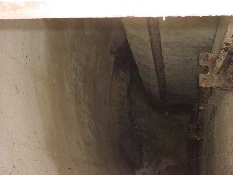
Foto 6 Vista de una compuerta de control de flujo.
