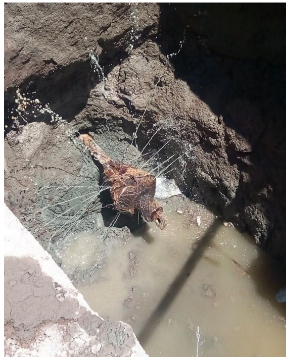
Imagen 54, punta para retroensanchado final, se observa como expulsa una mezcla de agua, polímeros y bentonita que sirven para controlar las paredes de la perforación 2 .
