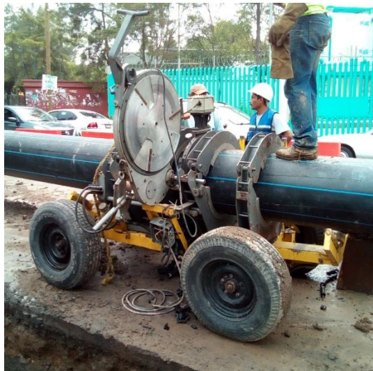
Imagen 21, carro de termofusión, alineación y escarificación de cada extremo de la tubería 2 .
