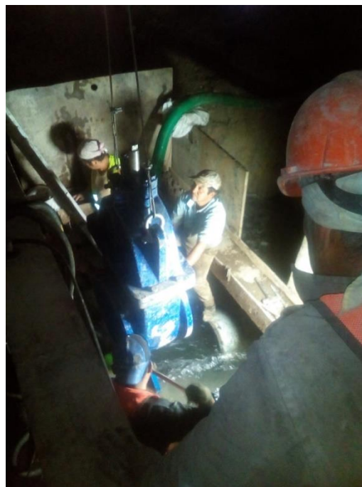
Imagen 67, instalación de válvula de compuerta, para controlar la salida de agua de la línea de asbesto cemento 2 .
