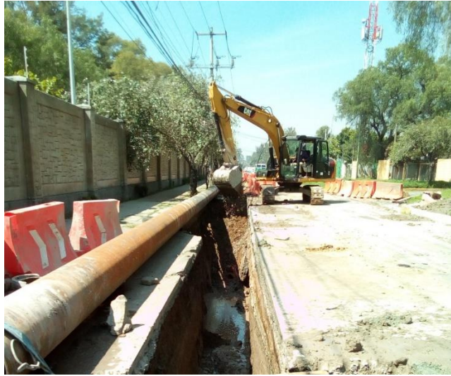
Imagen 42, excavación adicional para guía de tubería de acero y que entre alineada a la perforación.
