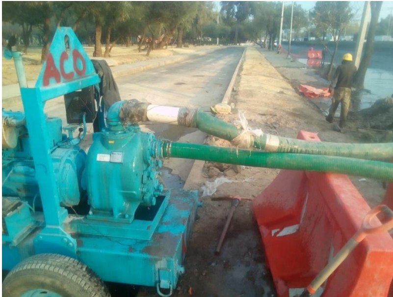
Imagen 66, equipo de bombeo para achique de agua proveniente de la línea de asbesto cemento 2 .
