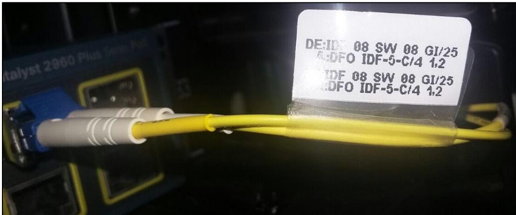
Figura 7.6 Etiquetado de jumper de fibra óptica
