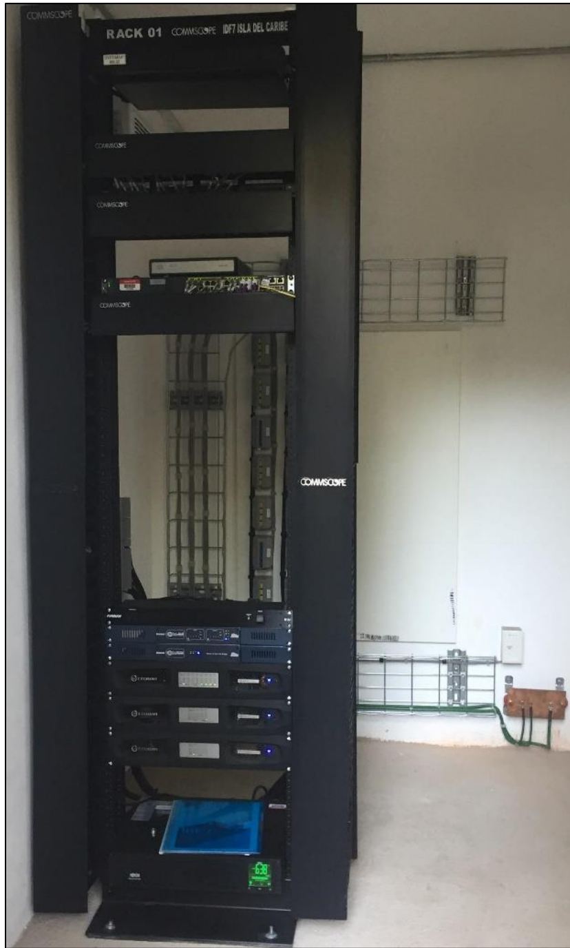
Figura 7.11 Imagen frontal de rack del IDF 7
