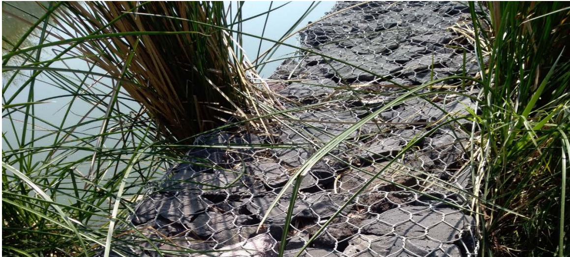
Figura 5-6. Muro gavión en el sistema.
