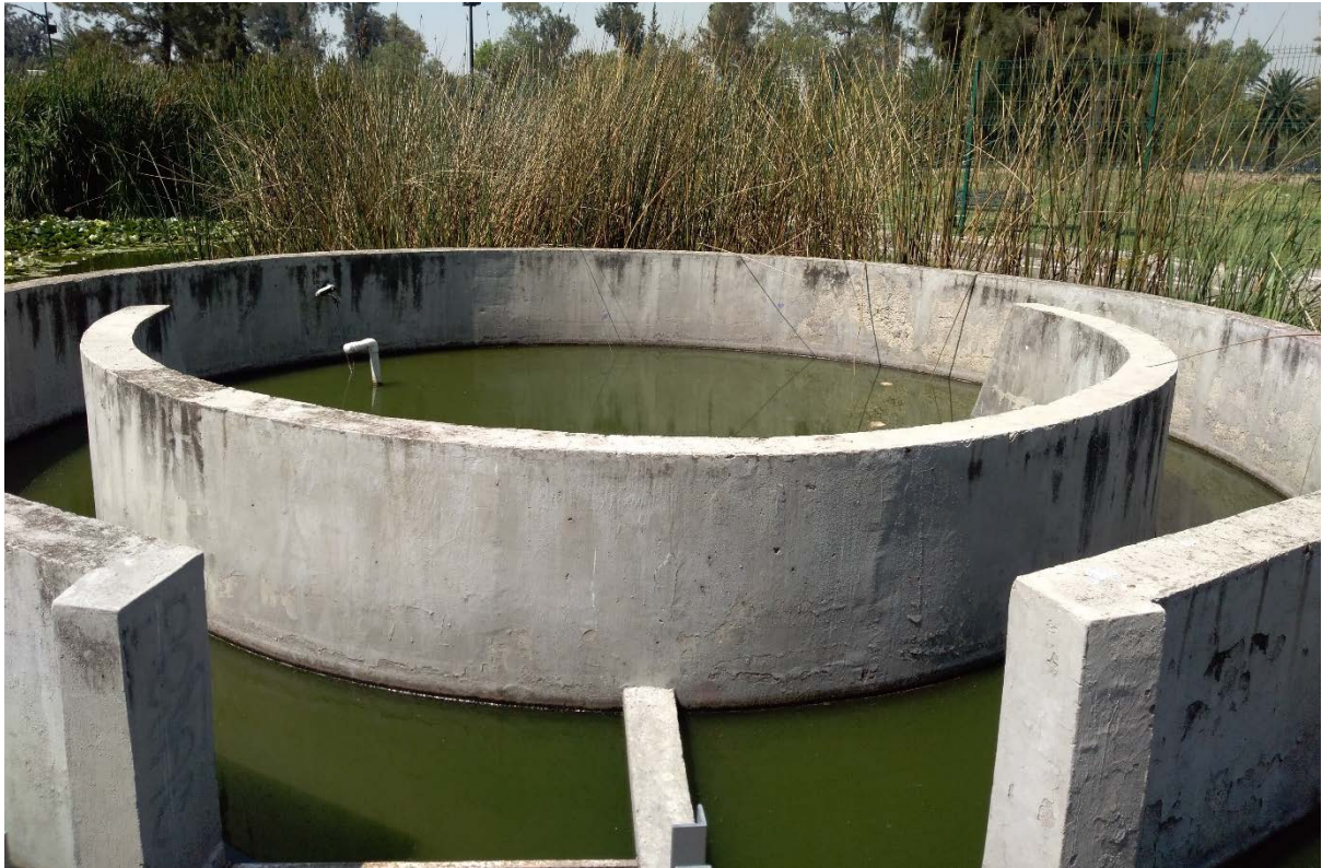
Figura 5-4. Sedimentador en el sistema.
