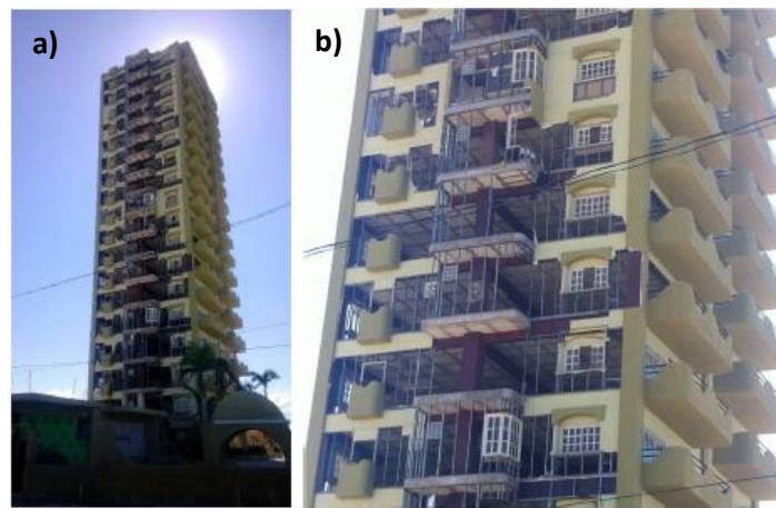
Figura 1.1 Daño en fachada de edificio de departamentos (Muria, et. al., 2015)
