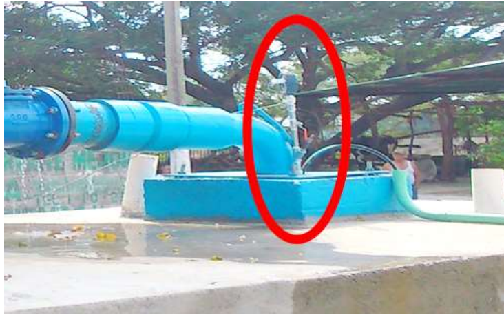
Figura 2-12.- Toma fotográfica de instalación real de manómetro de descarga.
