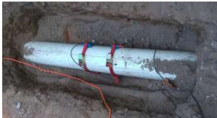
Figura 2-7.- Instalación de transductores TS-01 de medidor de flujo ultrasónico
