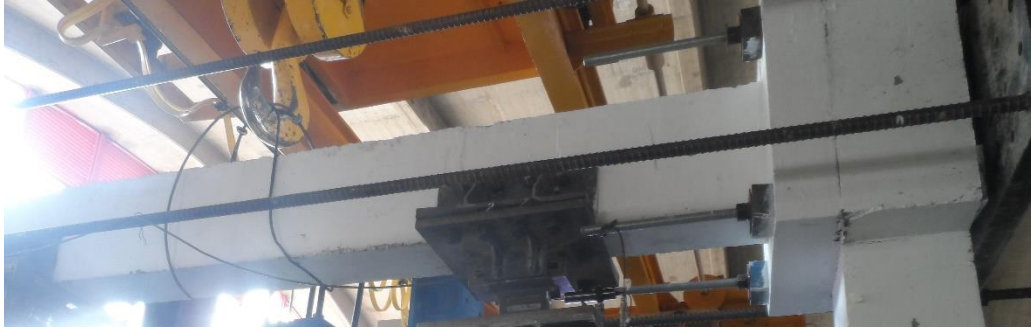
Figura 4.2 Trabe después de las pruebas (sin daños)
