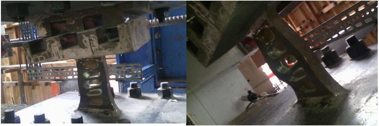
Figura 4.4 Daños en disipadores tipo 1
