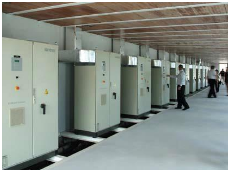
Figura 5. 1: Instalación fotovoltaica de Asur, España [5.3]
