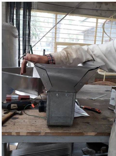
Fig. 141 Vista frontal del difusor ensamblado al soplador con tornillos autoperforantes y con sello de neopreno
