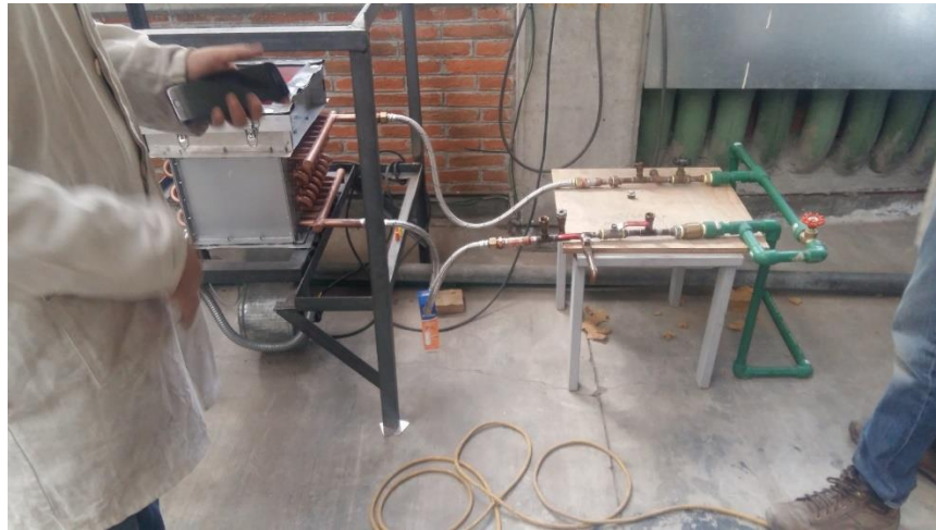
Fig. 183 Sistema hidráulico del DGA VERTICAL hacia el deshidratador
