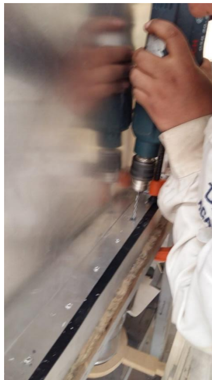
Fig. 85 Barrenado del neopreno y el PTR para la unión con la lámina de aluminio por medio de remaches
