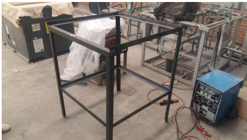
Fig. 121 Estructura del deshidratador con las patas y el marco inferior soldados
