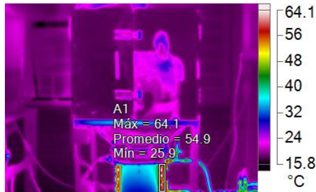
Fig. 202 Captura termográfica del DGA VERTICAL
