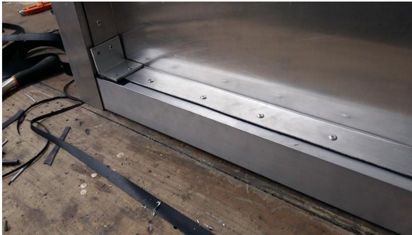
Fig. 86 Colocación de los remaches y corte del sello de neopreno a medida
