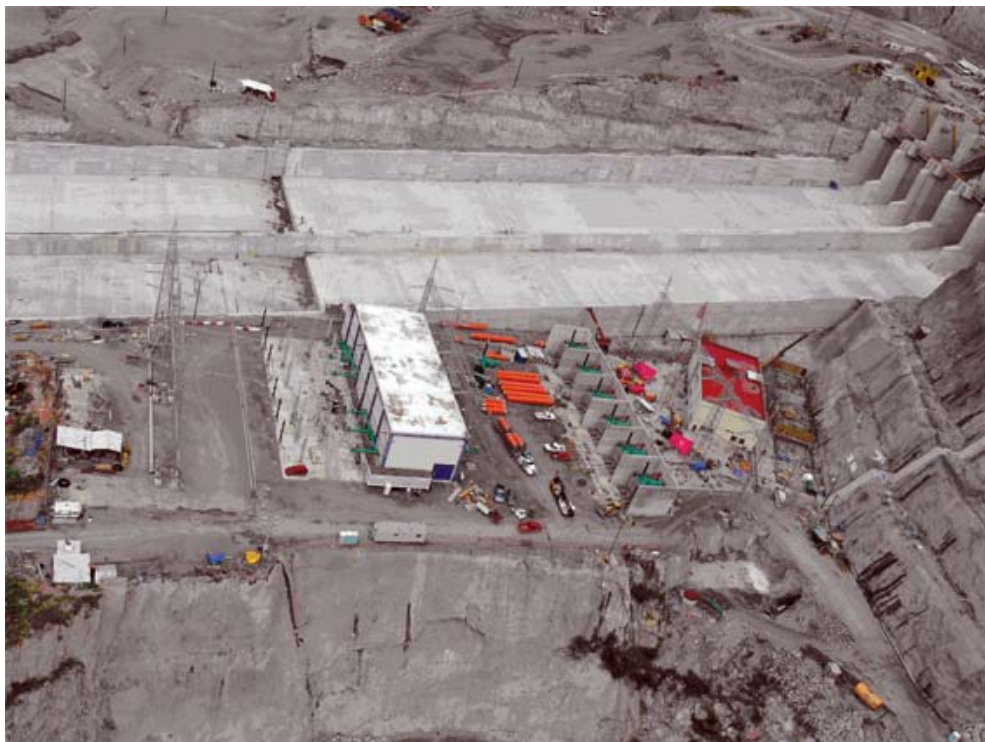
Fig. 2.24 Vista aérea de la subestación
