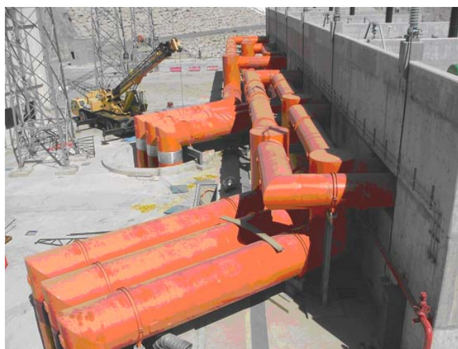
Fig. 2.30 Bus de fase aislada desde las lumbreras hasta los transformadores
