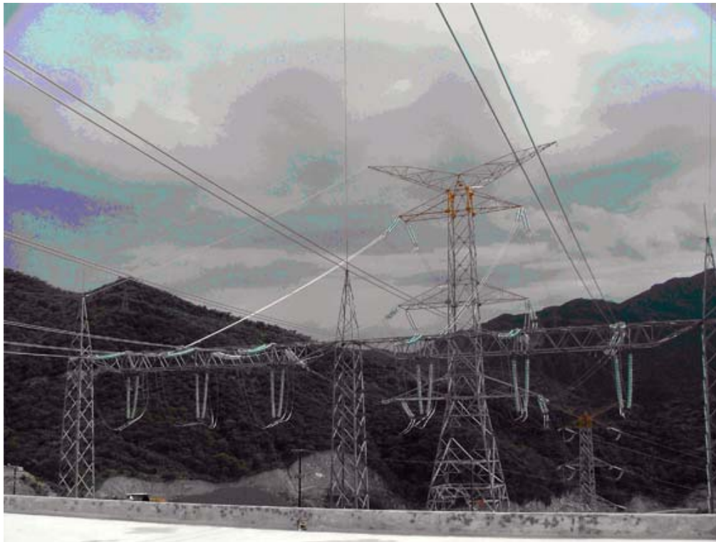
Fig. 2.31 Líneas de transmisión
