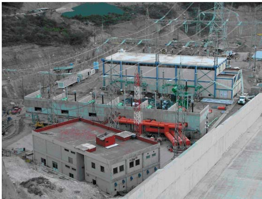
Fig. 2.29 Vista general de la subestación
