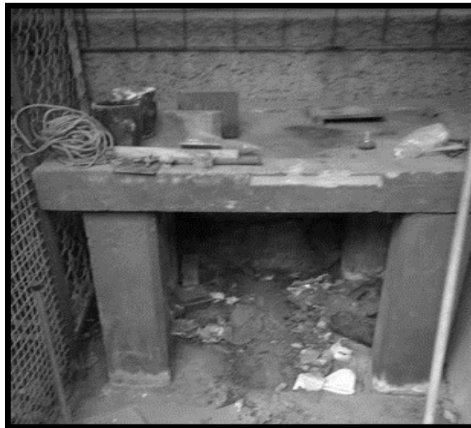
Figura 4.5 Mesa de concreto antes de rehabilitarla.
