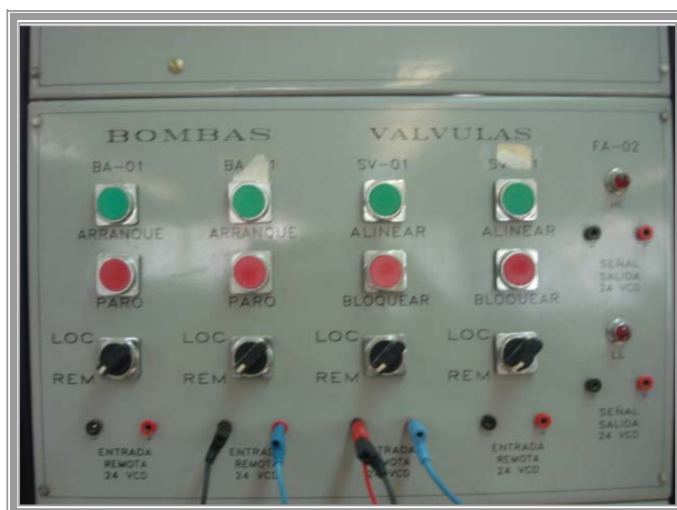
Figura 3.21. Foto Gabinete de conexiones.
