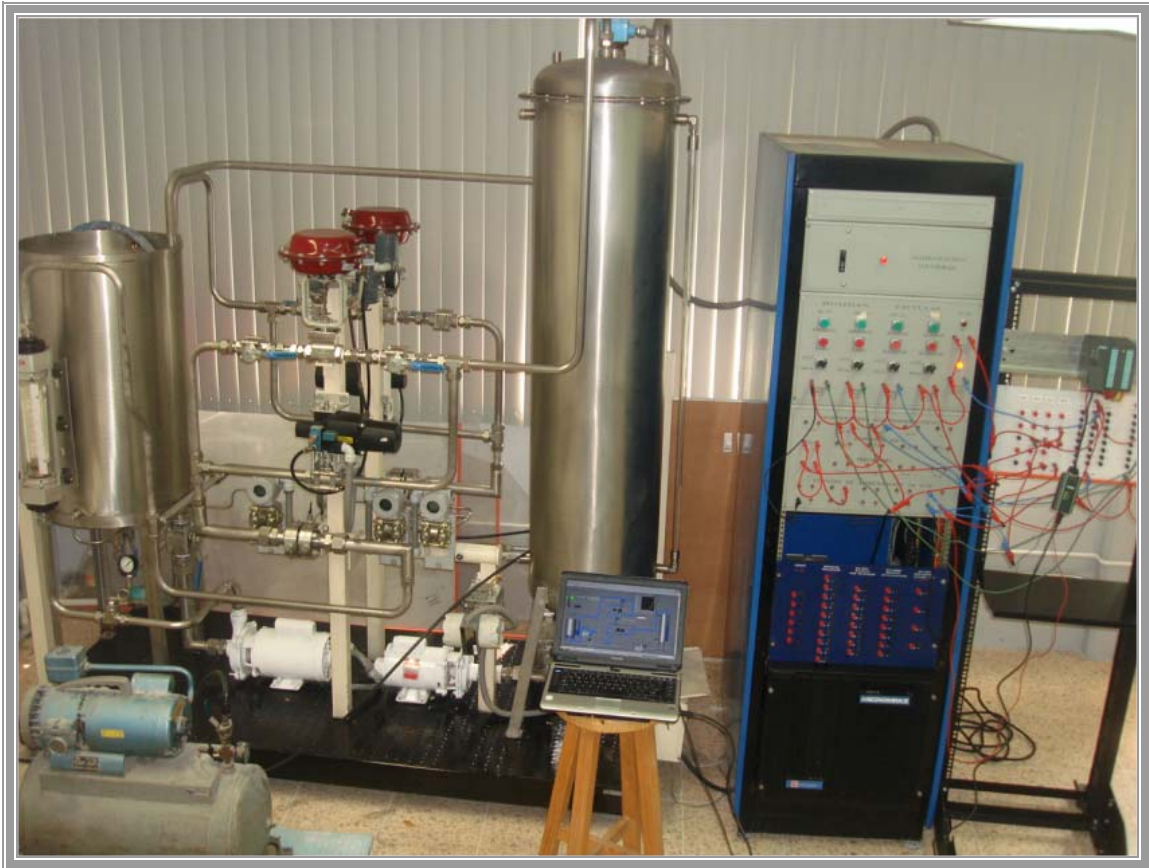
Figura 4.32. Foto de la planta piloto para el proceso de Control y Monitoreo SCADA.
