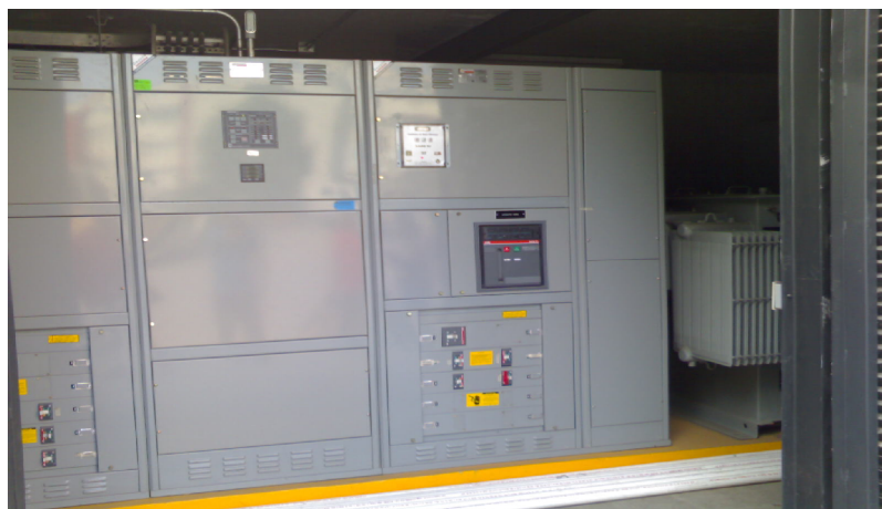
Fig. 14: Tablero con acoplamiento al transformador
