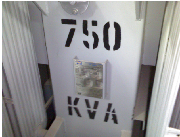
Fig. 8: Ejemplo de transformador con exceso de capacidad
