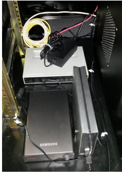
Fotografía 10. Detalle de cableado y discos duros externos dentro del gabinete.
