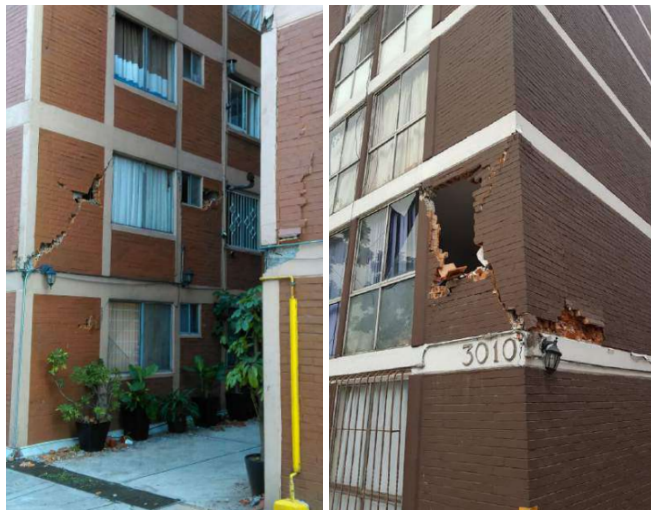
Figura 1.26 Falla en confinamiento de muros en edificios habitacionales (fotografías por Alberto Baldovinos, 2017)
