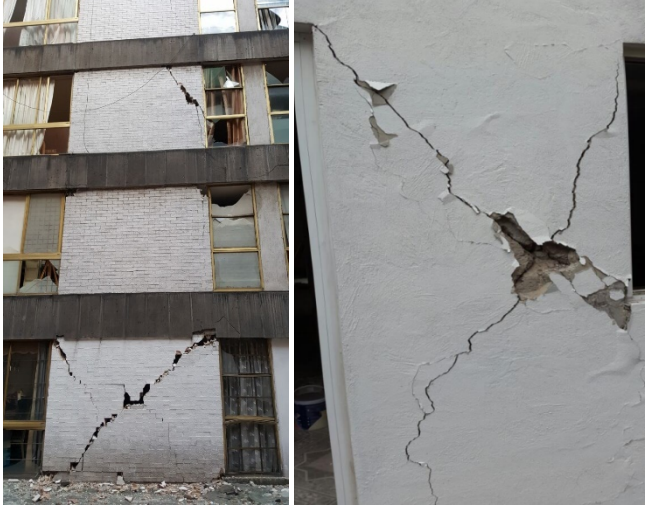
Figura 1.25 Muros con falla por cortante por falta de confinamiento (fotografías por Andrés Priego y Ángel Moreno, 2017)
