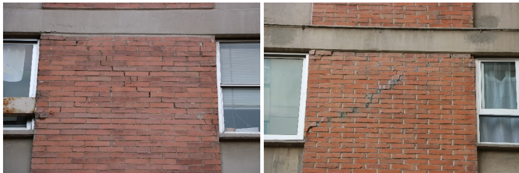
Figura 2.13 Muros de los edificios tipo D y E con daños por cortante, el de la derecha exhibe una reparación incorrecta (archivo personal, 2018)
