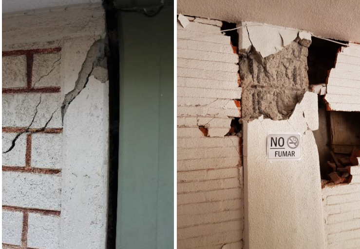
Figura 1.27 Columnas con daños por cortante y en recubrimiento en edificios habitacionales de la Ciudad de México (fotografías por Pablo Pardavé y Andrés Priego, 2017)
