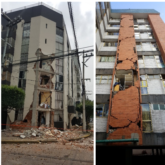
Figura 1.24 Edificios con daños en la cubierta de mampostería en la Colonia del Valle (fotografías por Ángel Tolen, 2017)
