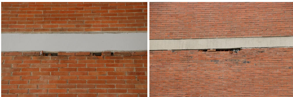
Figura 2.14 Muros diafragma dañados en la zona de contacto con las losas planas en los edificios tipo D y E (archivo personal, 2018)
