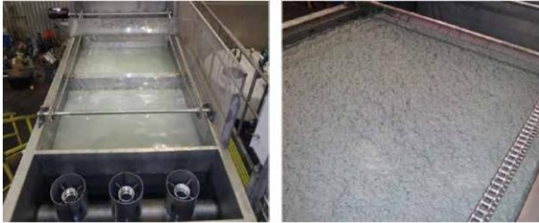
Figura 14. Sistema de flotación en funcionamiento (Fuente: Operación y Mantenimiento de Plantas de Tratamiento de Aguas, CONAGUA).
