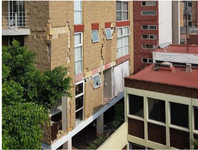
(2017) Daños en Inmueble de Eje 5 Sur Tafuya O. Sismo 11 Septiembre “
