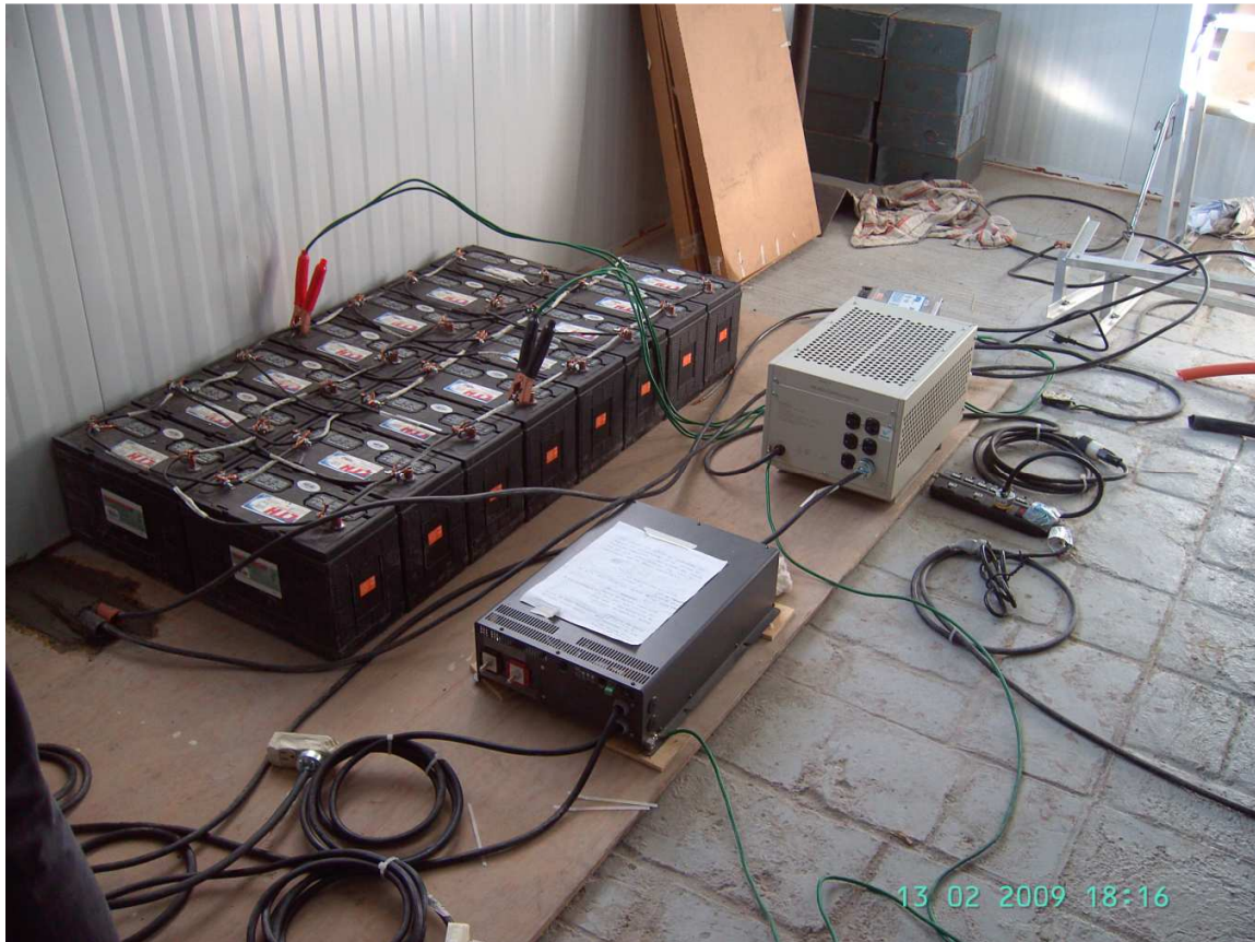
Figura 8.3 Banco de 15 baterías que forma parte del sistema de respaldo, posicionado y conectado en el sitio en que se mantendrá en operación.
