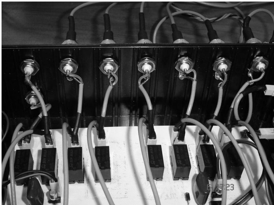
Figura 4.35. Chasis de relevadores por canal
