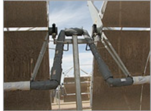
Figura 25. Unión entre módulos solares (Troughnet).
