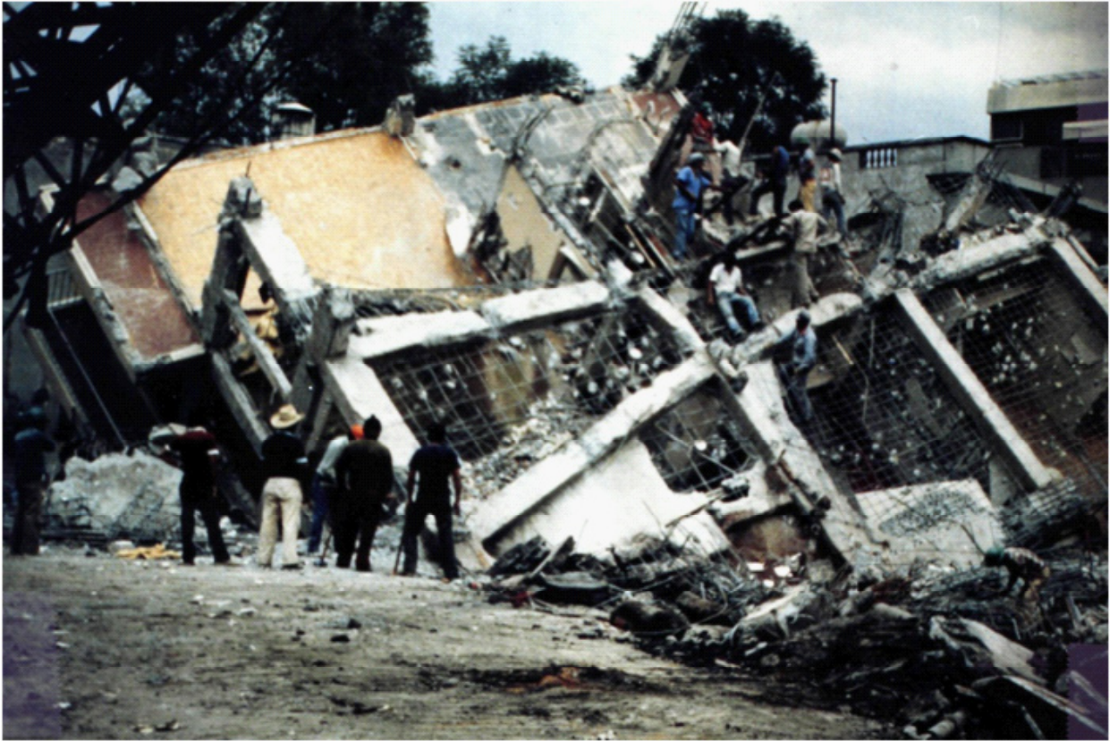
Edificio 10 pisos frente espacio abierto. Falla de pilotes de fricción
