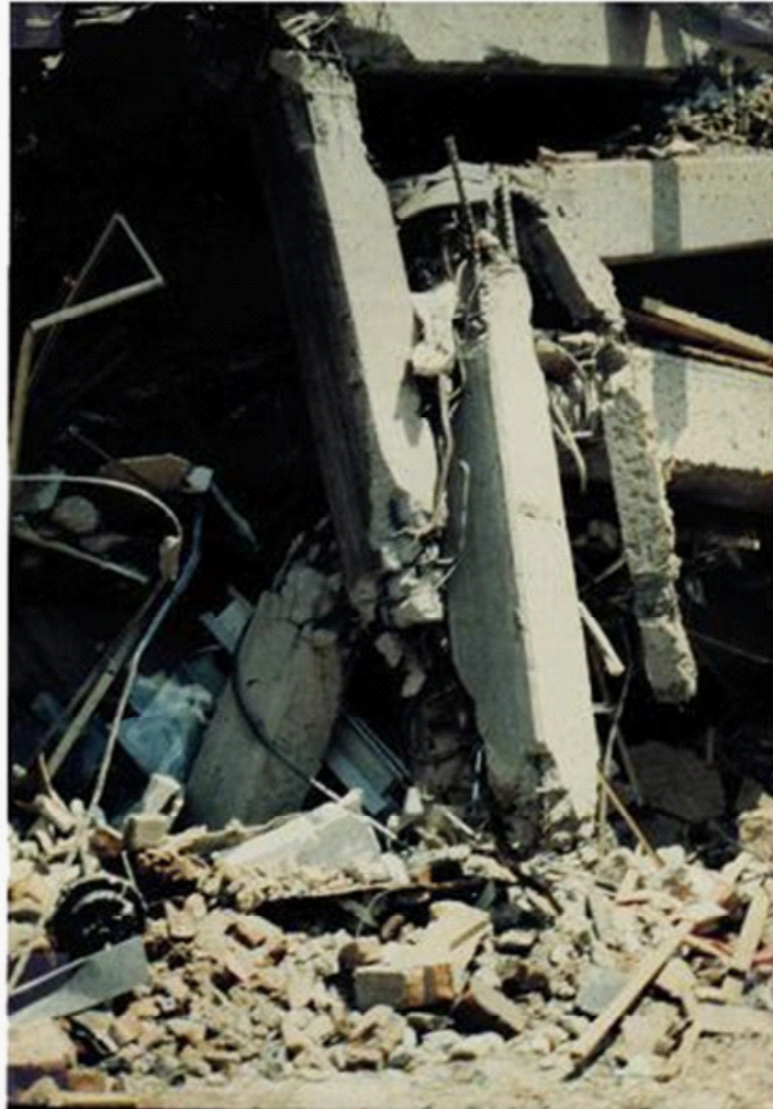
Colapso total de la edificación. Destrucción de columnas y trabes Falla de los nudos "rígidos Columnas y trabes permanecen
