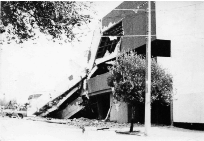
Volteo parte superior del edificio. Cambio brusco de sección
