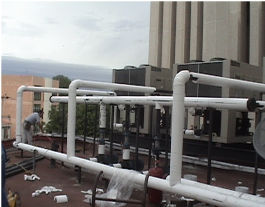
Figura 3.9 Recubrimiento aislante de Tubería de cobre
