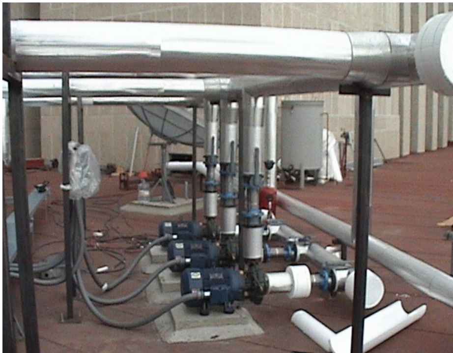
Figura 3.11 Bomba en sistema en Paralelo
