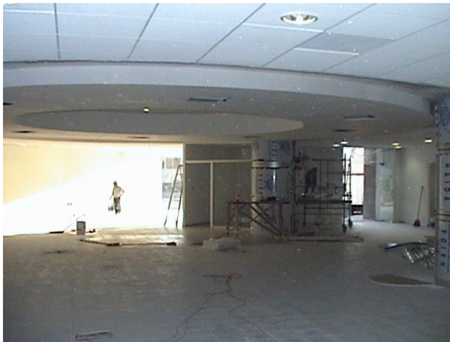
Figura 5.2 Proceso de Acabados en el área del Módulo de Atención al Contribuyente
