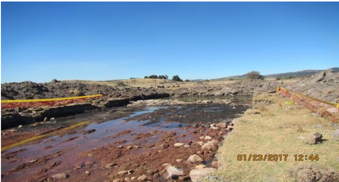
Ilustración 2 Presencia de suelos saturados CAD 87+708.00.
