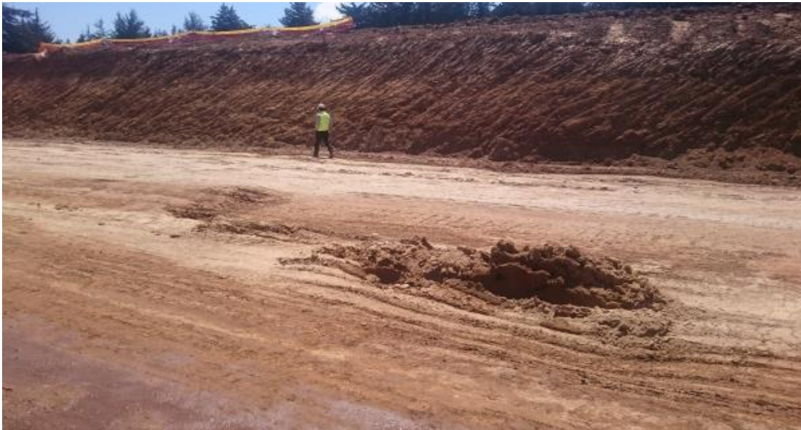
Ilustración 15 Formación de ondulaciones y baches, sub tramo 594+100 al 595+320.
