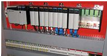
Figura 5.2 PLC moderno instalado (2008) dentro del tablero eléctrico
