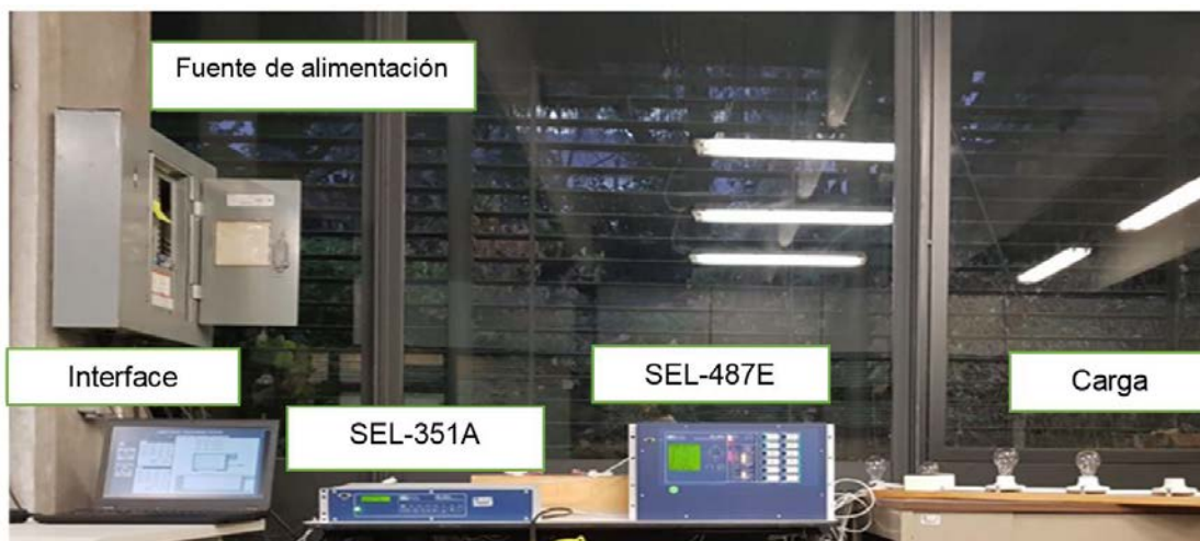
Figura 4.7 Instalaciones de la red de prueba en el laboratorio de Electrónica de Potencia
