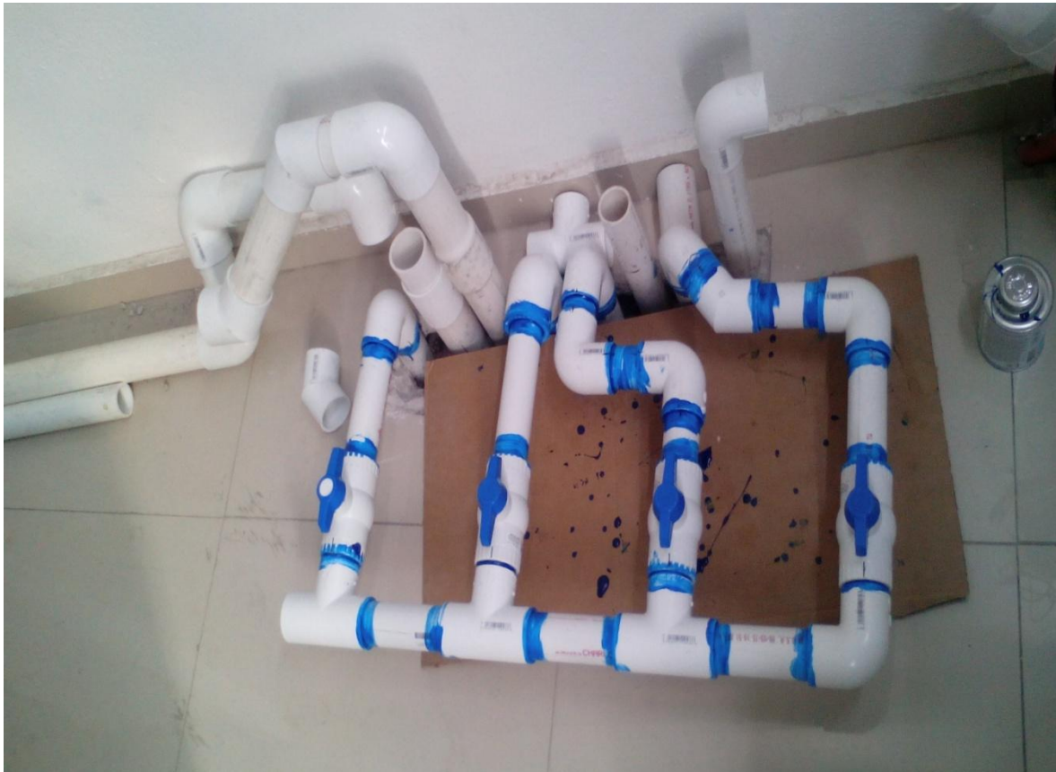
Fig. 41: Conexión de válvulas en conexión hidráulica de 1 ½ pulgada
