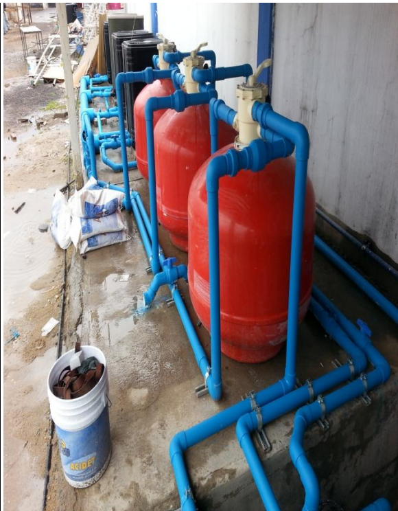
Fig. 31: Tubería de motobomba a filtro
