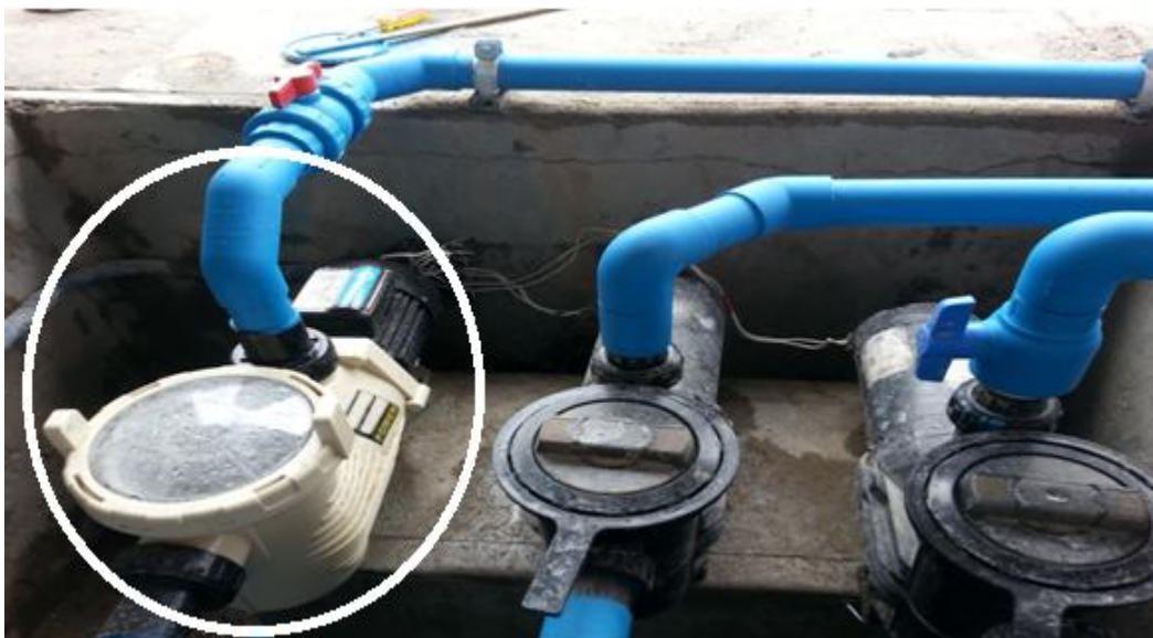
Fig. 35 Vista frontal de las motobombas instaladas
