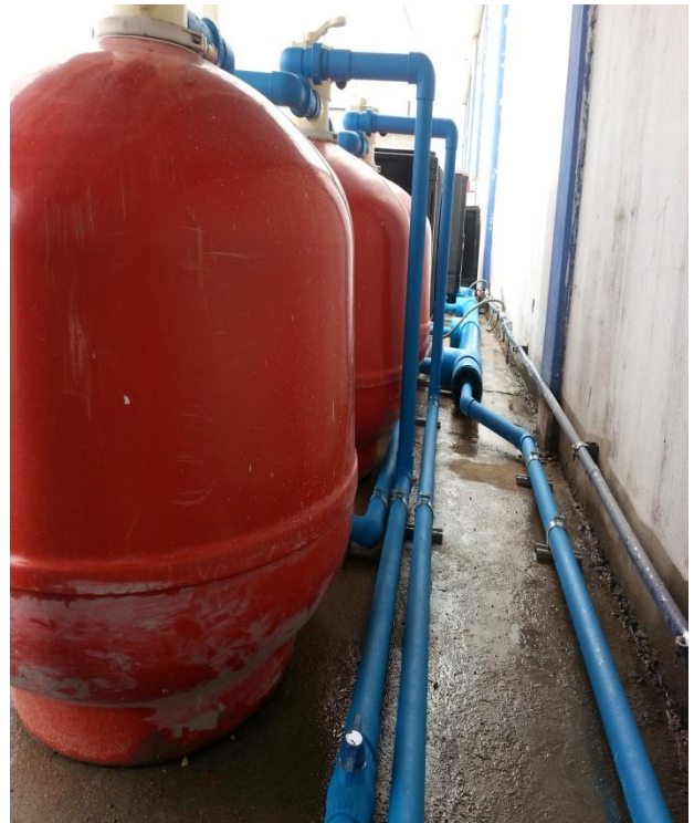
Fig. 32: Tubería de filtro a retorno
