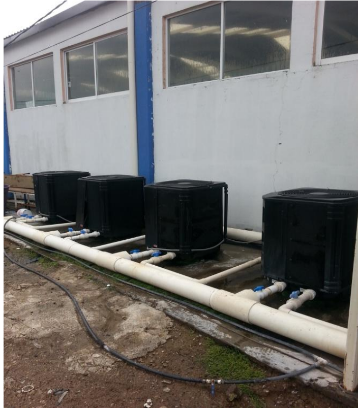
Fig. 24: Bombas de calor antes de modificar
