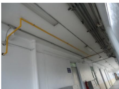
Instalación de gas en laboratorio de panadería
