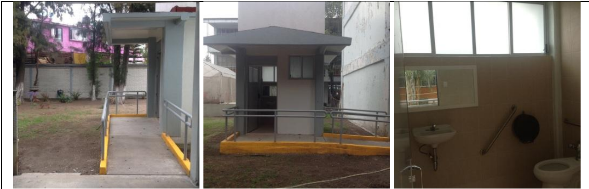
Sanitario Nuevo para personas con discapacidad
