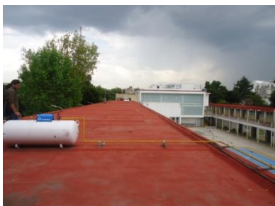
Tanque de gas estacionario en azotea
