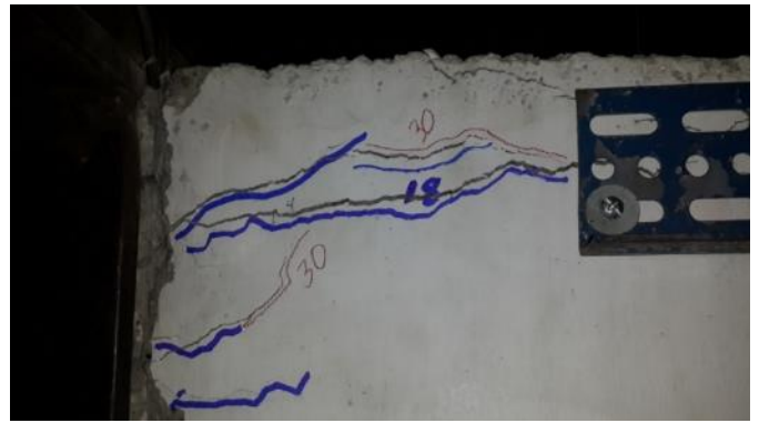
Fig. 2.30 Formación de grietas a diferentes desplazamientos
