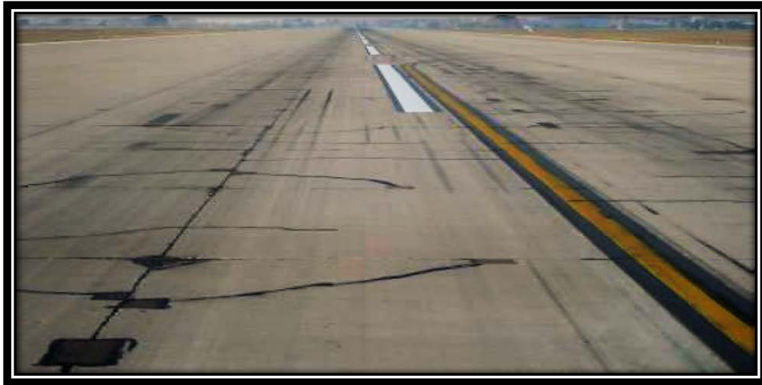
Imagen 15 Grietas de esquina y longitudinales en pistas
