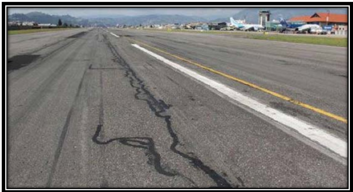
Imagen 13 Bacheo, grietas y roderas en pistas
