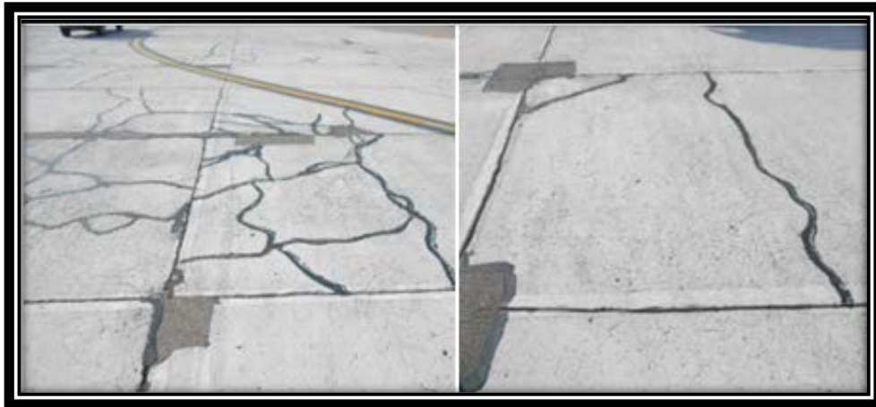
Imagen 14 Grietas de esquina y longitudinales en calles de rodaje
