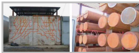
Figura 4.11- Cuarto de los cilindros de almacenamiento de hidrógeno con una ventilación adecuada (Tanaka y col., 2007)
