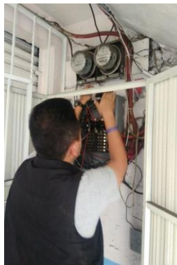
Figura 4.29. Identificación de líneas de suministro
