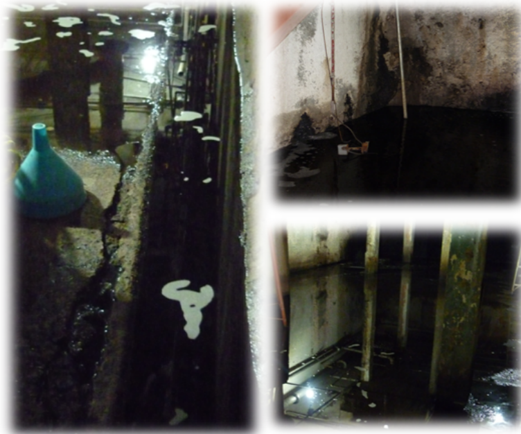
Figura 6.8. Tanque de almacenamiento de agua residual de una de las industrias en estudio
