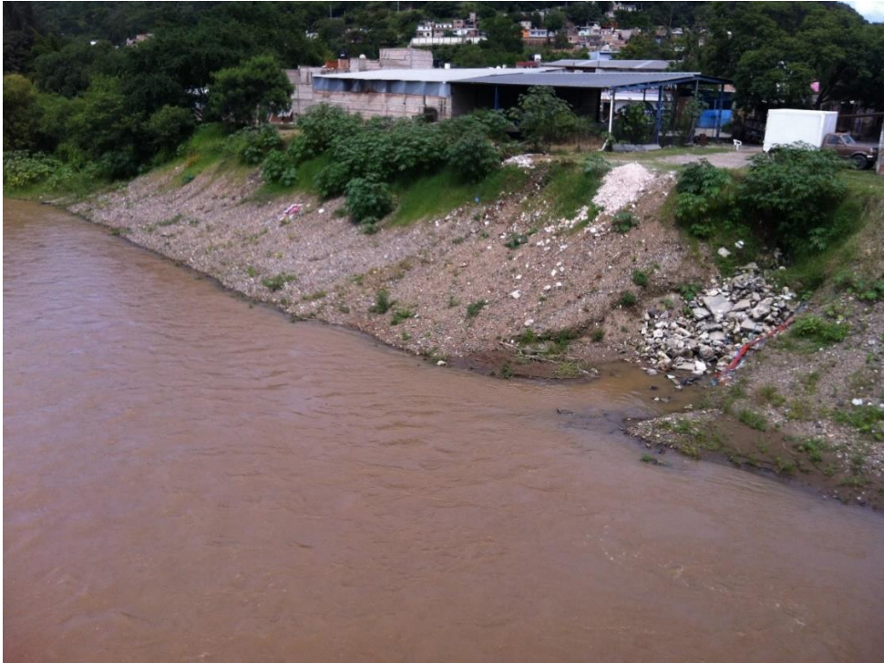
Figura 3. Descarga de agua residual y erosión en la margen derecha*.
