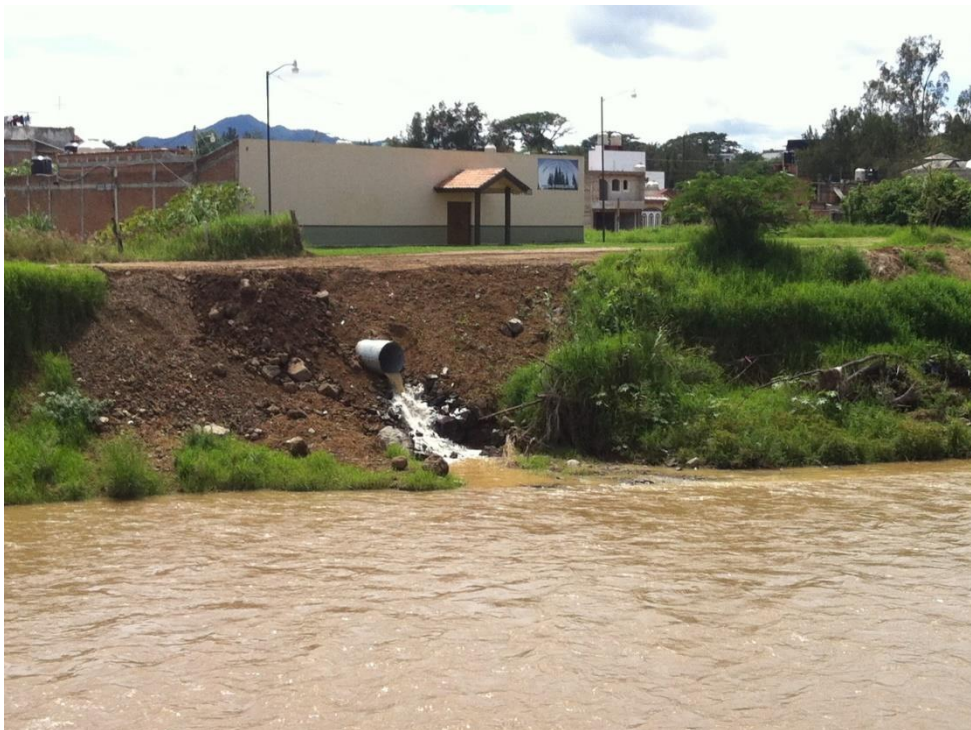
Figura 5. Descarga de aguas residuales en la margen izquierda.*
