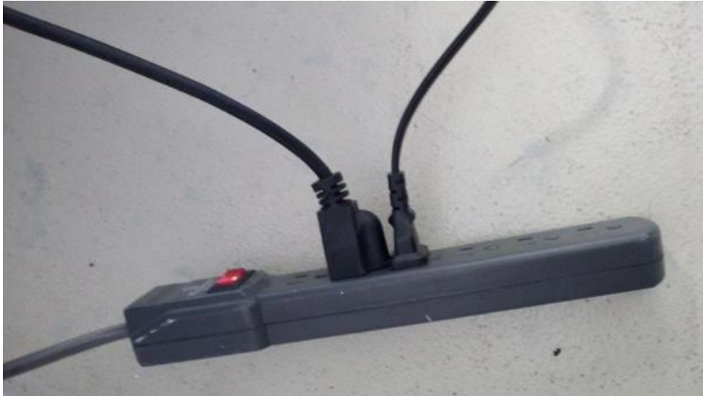
Figura 8.2 Conexión a la energía eléctrica.
