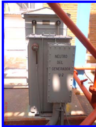
Figura 5.5 Puesta a tierra del neutro del generador de la unidad 2
