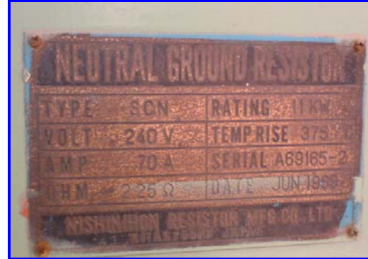
Figura 1.45 Placa de datos de la resistencia de puesta a tierra de los transformadores de servicios propios de las unidades 2 y 3.
