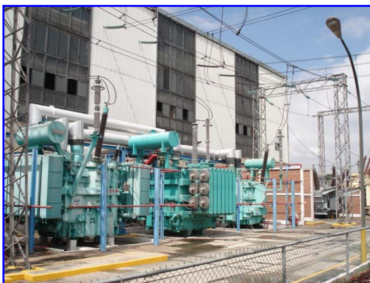
Figura 1.25 Banco de transformadores monofásicos de la Unidad 4.
