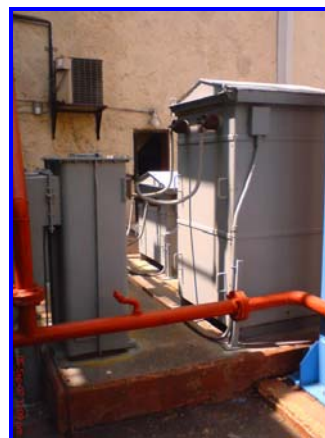
Figura 1.43 Puesta a tierra del Generador y el Transformador de servicios propios de la Unidad 3.
