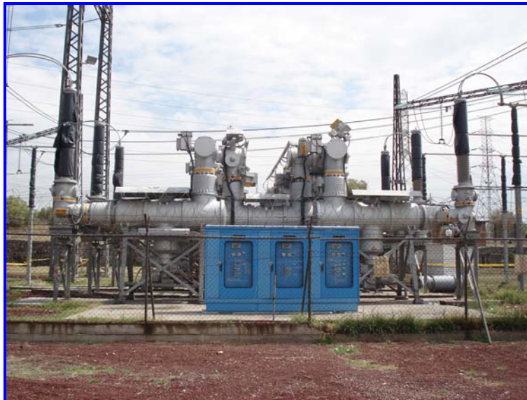
Figura 4.5 Subestación en SF6 230 kV.
