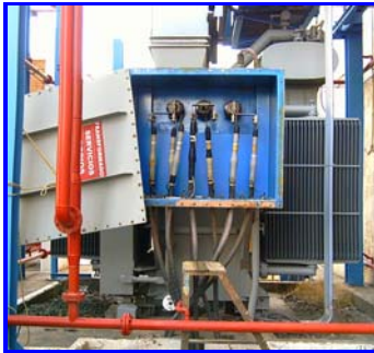
Figura 4.8 Transformador de servicios propios U2
