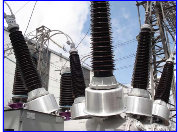
Figura 1.32 Interruptor de tanque muerto.
