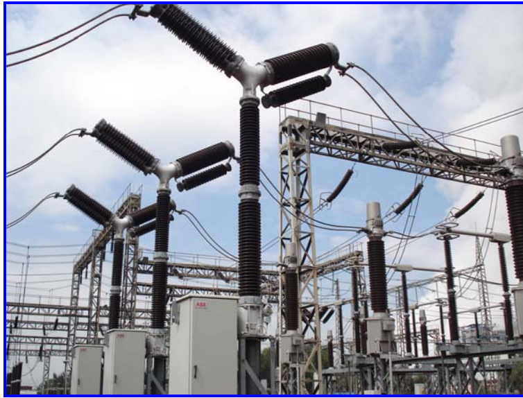
Figura 1.28 Interruptor tanque vivo.
