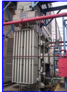
Figura 4.9 Transformador de servicios propios U-1
