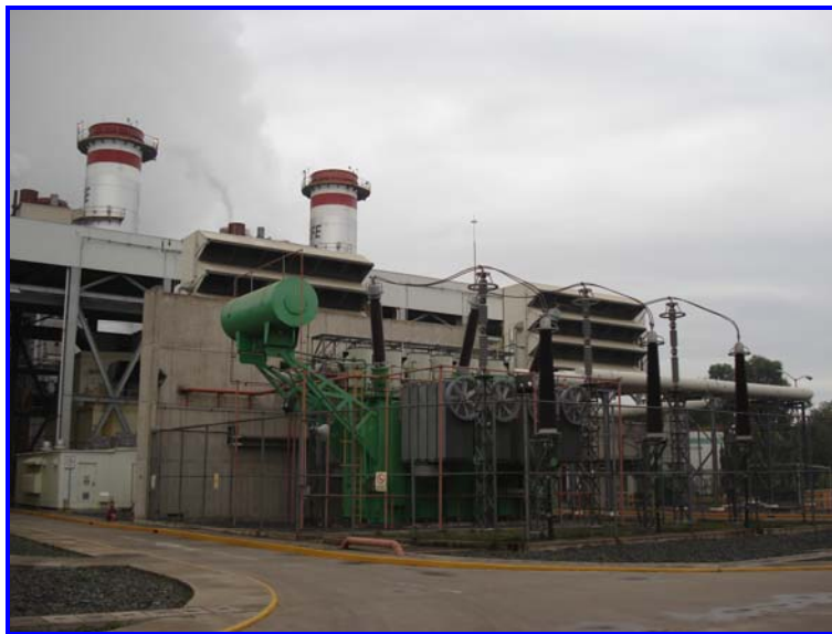
Figura 1.27 Transformador para las Unidades 6 y 7.
