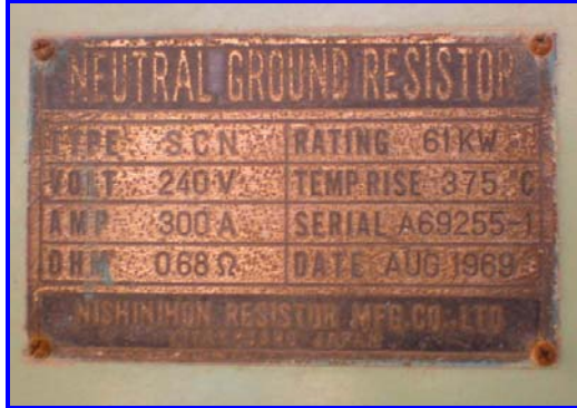
Figura 1.44 Placa de datos de la resistencia de puesta a tierra de los Generadores 2 y 3.
