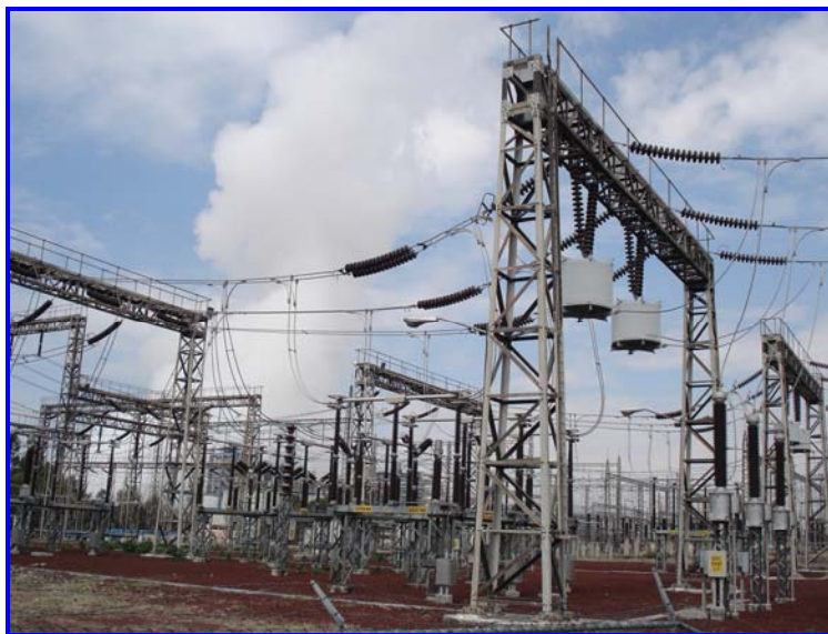
Figura 4.1 Subestación tipo exterior 230 kV.
