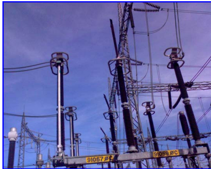
Figura 1.34 Cuchilla de apertura horizontal, con cuchilla de puesta a tierra.
