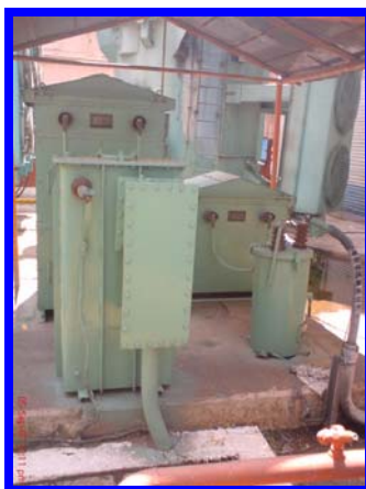
Figura 5.8 (Derecha) Puesta a tierra del neutro del transformador de servicios propios de la unidad 3
