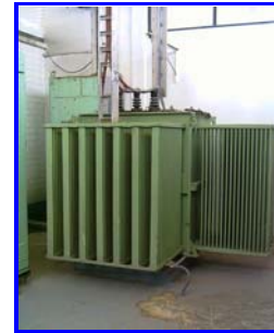
Figura 4.10 Transformador torre de enfriamiento U1
