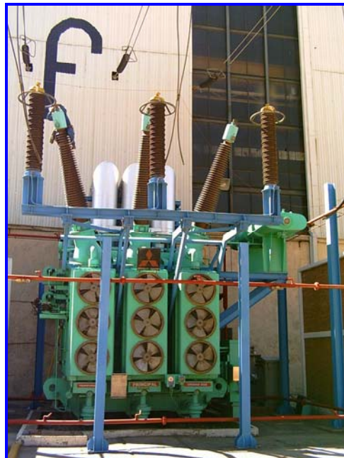
Figura 1.24 Transformador Unidades 2 y 3.
