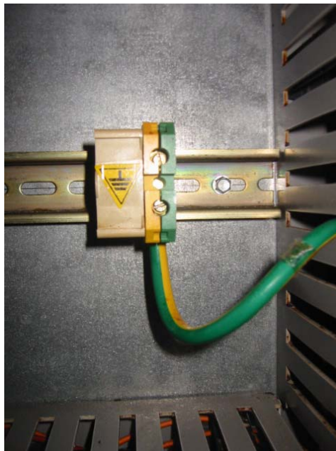
Fig. 6.1 Clema para conductores de puesta a tierra aislada
