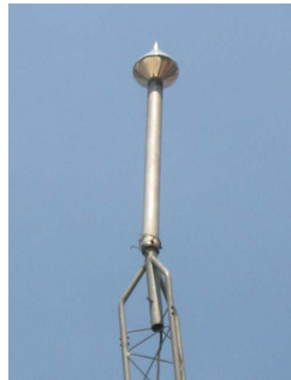
Fig. 7.15.- Punta pararrayo existente.
