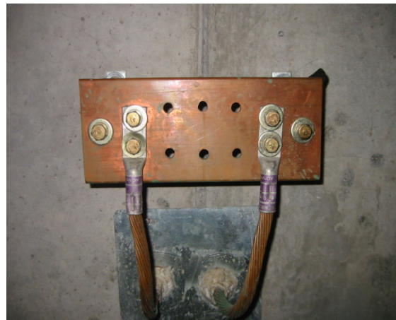
Fig. 2.11.- Barra de unión de cobre con zapatas de doble ojillo.
