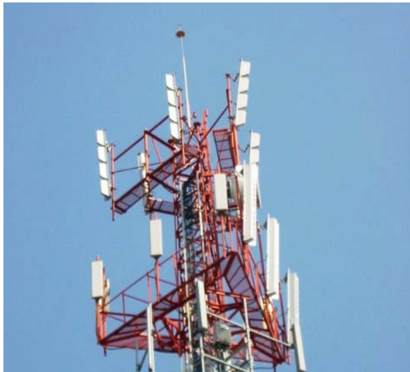
Fig. 3.2.- Ejemplo de antena receptora de señales, con pararrayos.
