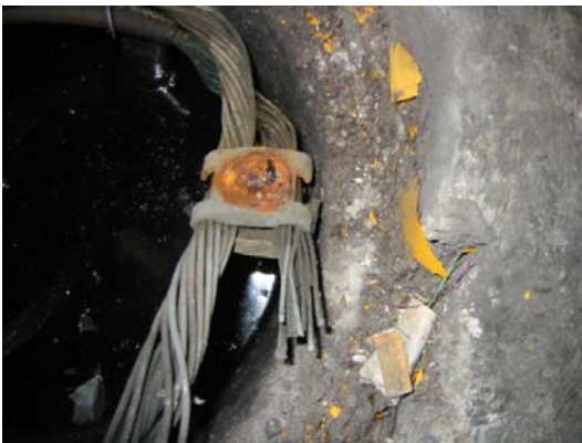
Fig. 7.1.- Sistema de puesta a tierra en mal estado. Se nota presencia de óxido en conector y conductores, además de presencia de suciedad en el registro de medición tipo circular.
