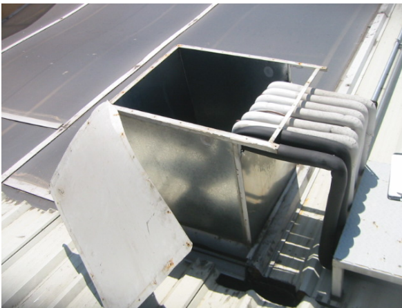
Fig. 7.17a- Estructura metálica no puesta a tierra, incumpliendo el Art. 250-32, sección D de la norma NOM-001-SEDE-2005.
