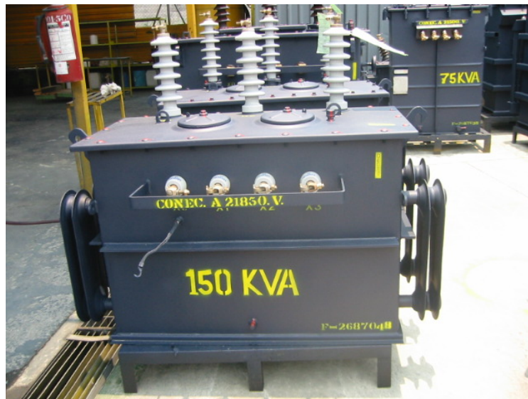
Fig. 5.3.- Transformador 150 [KVA] sumergido en aceite
