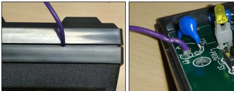
Figura 29 “Cable dañado por falta de espacio”
