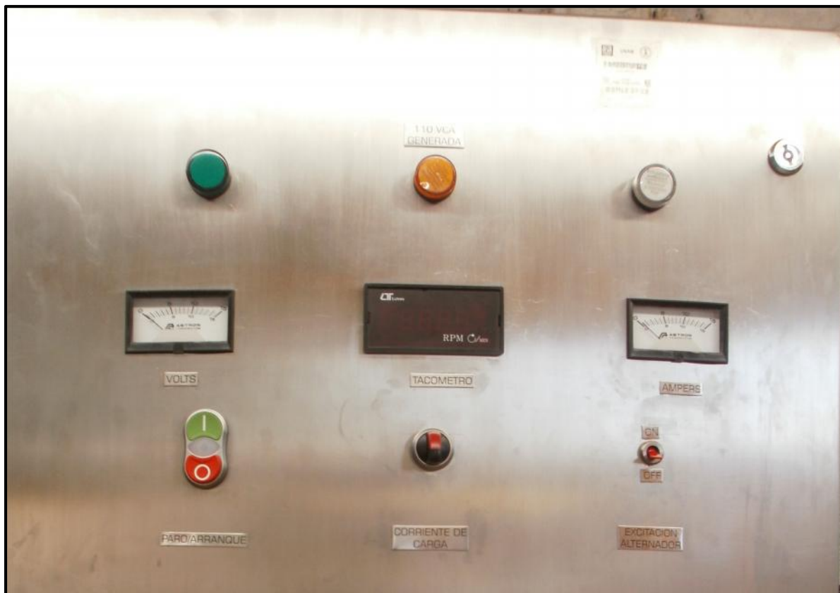
Figura 4.17 Tablero de control e instrumentación de la turbina
