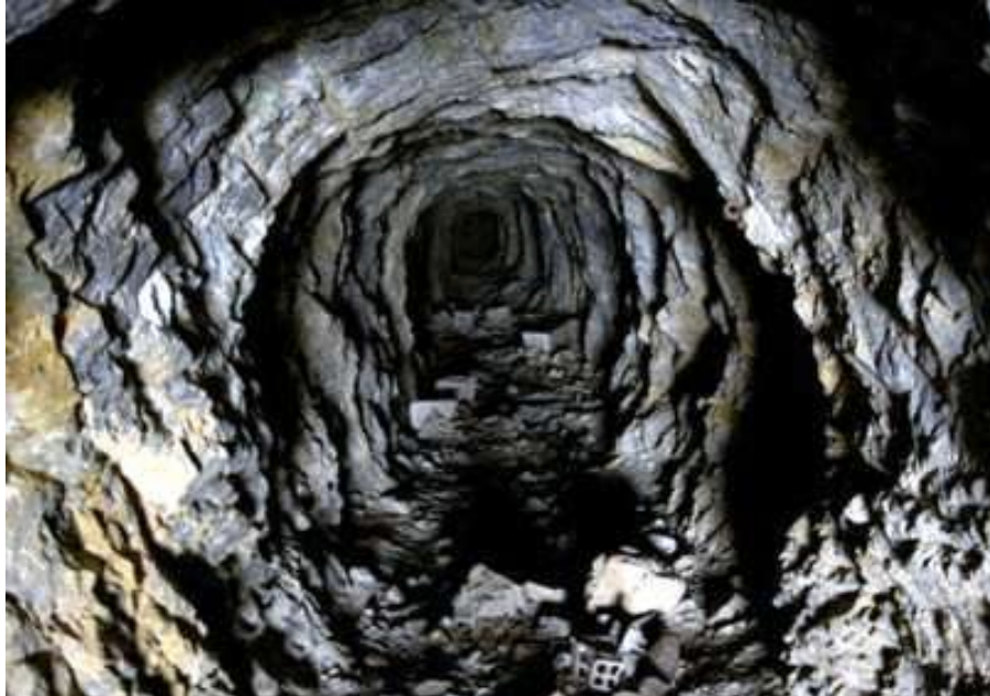
Imagen 1.- Túnel minero, el cual se utiliza para movilización dentro de la mina o sacar material, estas estructuras comúnmente son temporales. 1
