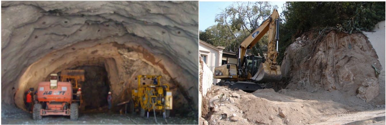
Imagen 8.- Excavación subterránea de un túnel, en la que se realiza un recubrimiento para darle mayor estabilidad (Izquierda) 10 , y excavación de talud en zona residencial (Derecha) 11 .
