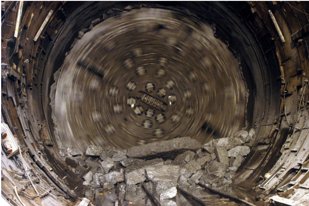
Imagen 2.- Tuneladora realizando túnel ferroviario, este tipo de obras requieren de una gran estabilidad dado que su carácter es “permanente”, Túnel Guadarrama Madrid, España. 2
