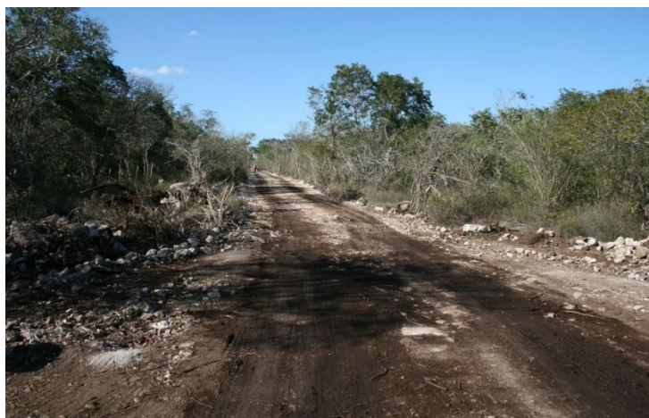
Figura 2.1. Desmonte sobre la carretera Tuxtla – Gutiérrez Cd. Cuauhtémoc
