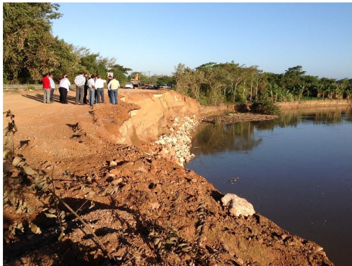
Falla de Terraplén
