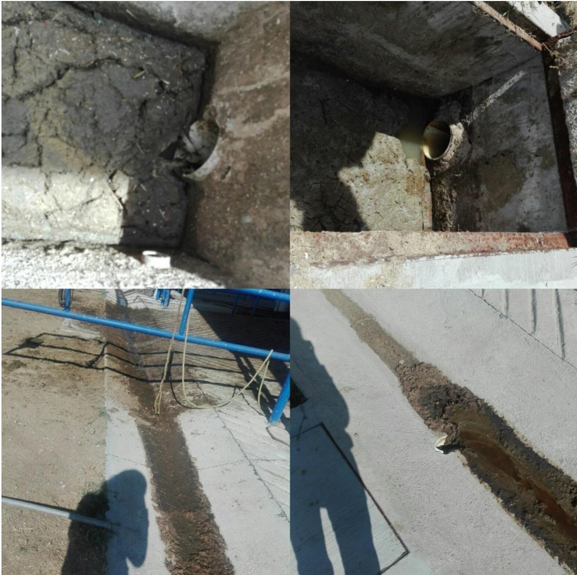
Figura 3.8. Registros y canal con agua residual estancada
