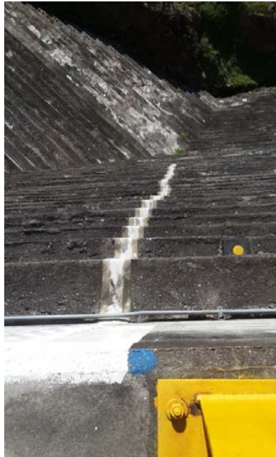
Figura 4- 27 Grieta vista hacia aguas abajo
