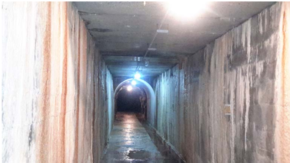
Figura 4-23 Galería de drenaje
