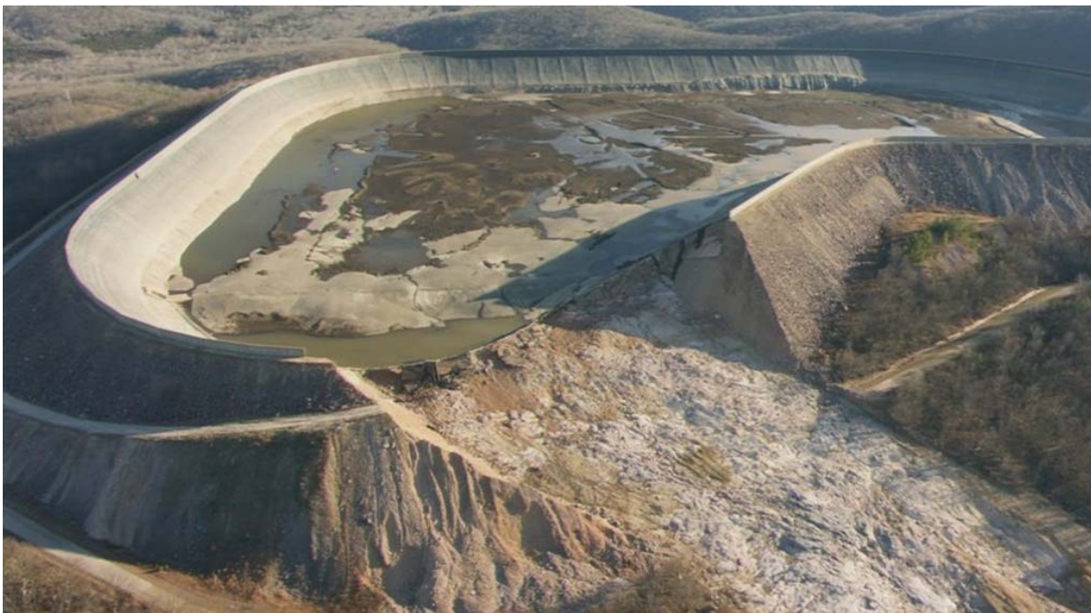
Figura 1- 12 Taum Sauk Upper Reservoir Plant- Después de la falla (Rizzo C., 2008)
