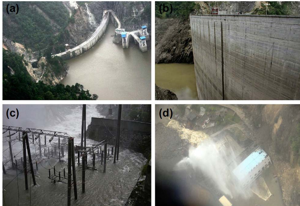
Figura 1- 19 Presa Shapai: a) Presa y obra de toma después del sismo de Wenchuan; b) No se observaron grietas en la presa después de vaciar el embalse; c) la subestación fue inundada; d) Tubería a presión fracturada y casa de máquinas inundada.
