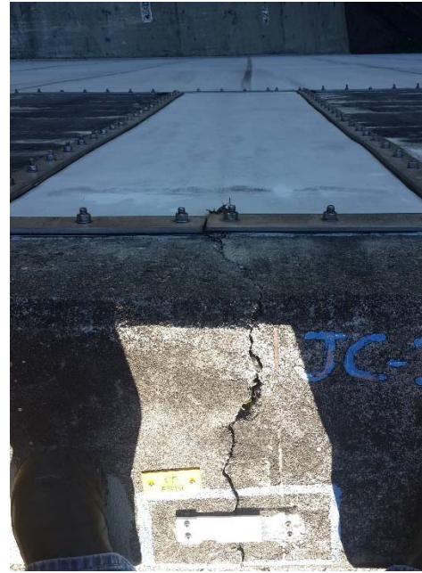
Figura 4- 28 Grieta vista aguas arriba
