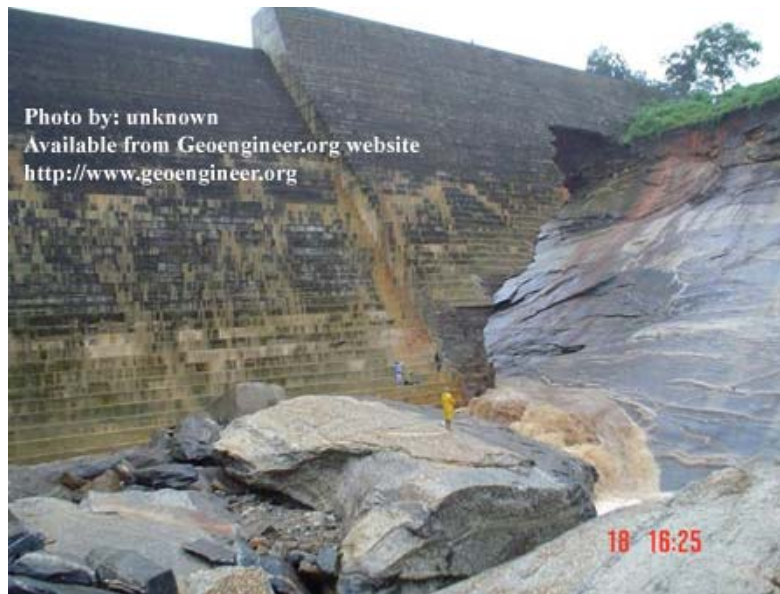
Figura 1- 16 Presa Camara de CCR (h=50 m) - Brasil 2004 - Efectos de Subpresión
