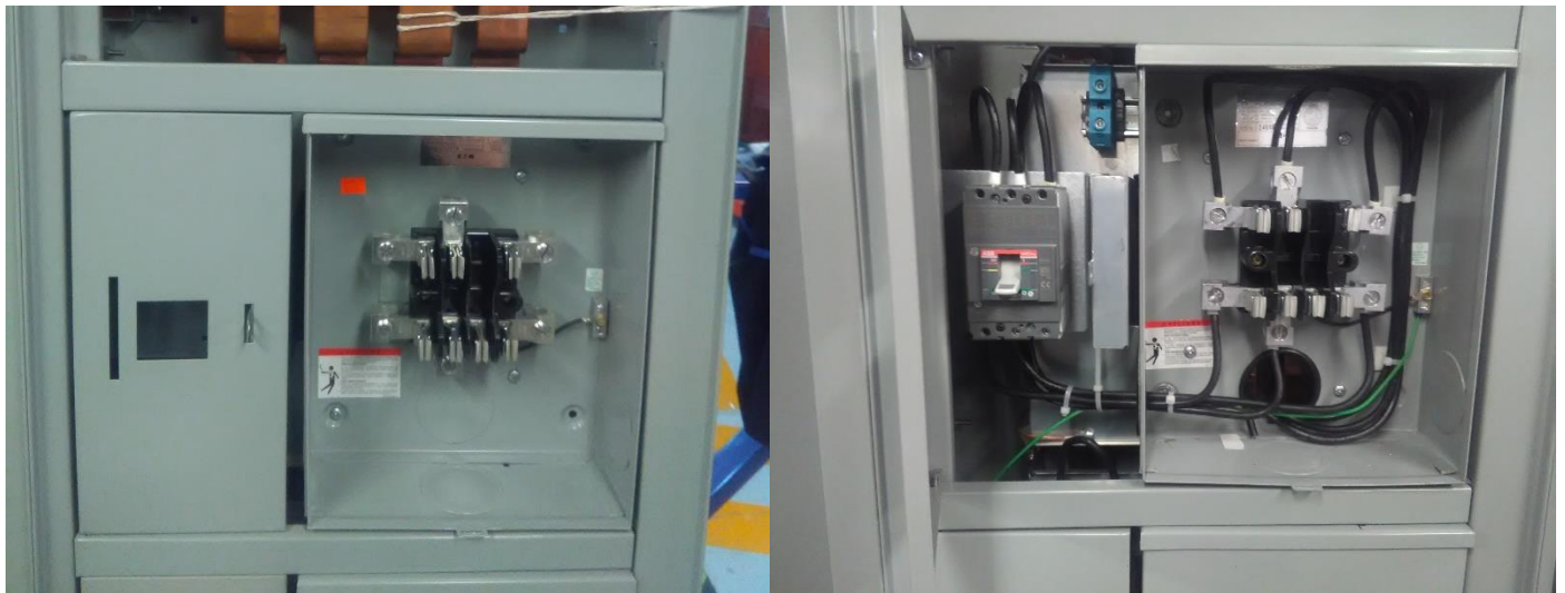
Fig. 7.25 Ensamble de puerta, platina de medidor y medidor dentro de la envolvente principal, se aprecia el knockhow para la alimentación de la base de medición todo empotrado en el kit para montaje de equipo de medición.
