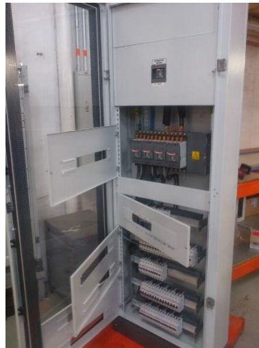
Fig. 3.4 Tablero de baja tensión modelo ArTu L® ensamblado con todos sus componentes ABB®, interruptores, alimentación, soportería y gabinete.
