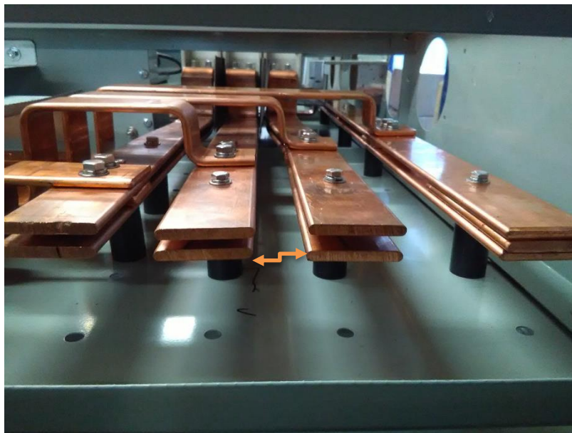
Fig. 7.15 En la imagen se aprecian las barras soportadas sobre cilindros aisladores donde la distancia entre barras se estandarizo y obedece a la NOM-001 además de estar en función de la posición de estos elementos aislantes.
