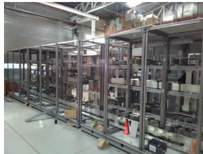
Fig. 3.2 Subestación de media tensión de 6300A en la cual se aprecia el arreglo de barras y soporteria.
