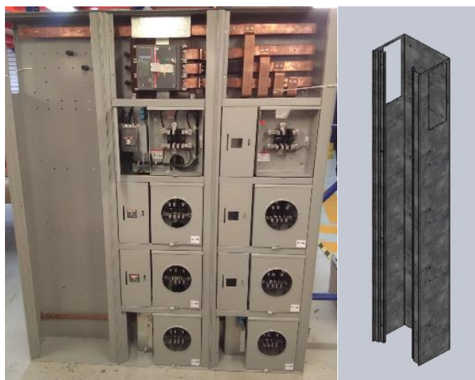
Fig. 7.9 El gabinete de acometida es el situado en la extrema izquierda.
