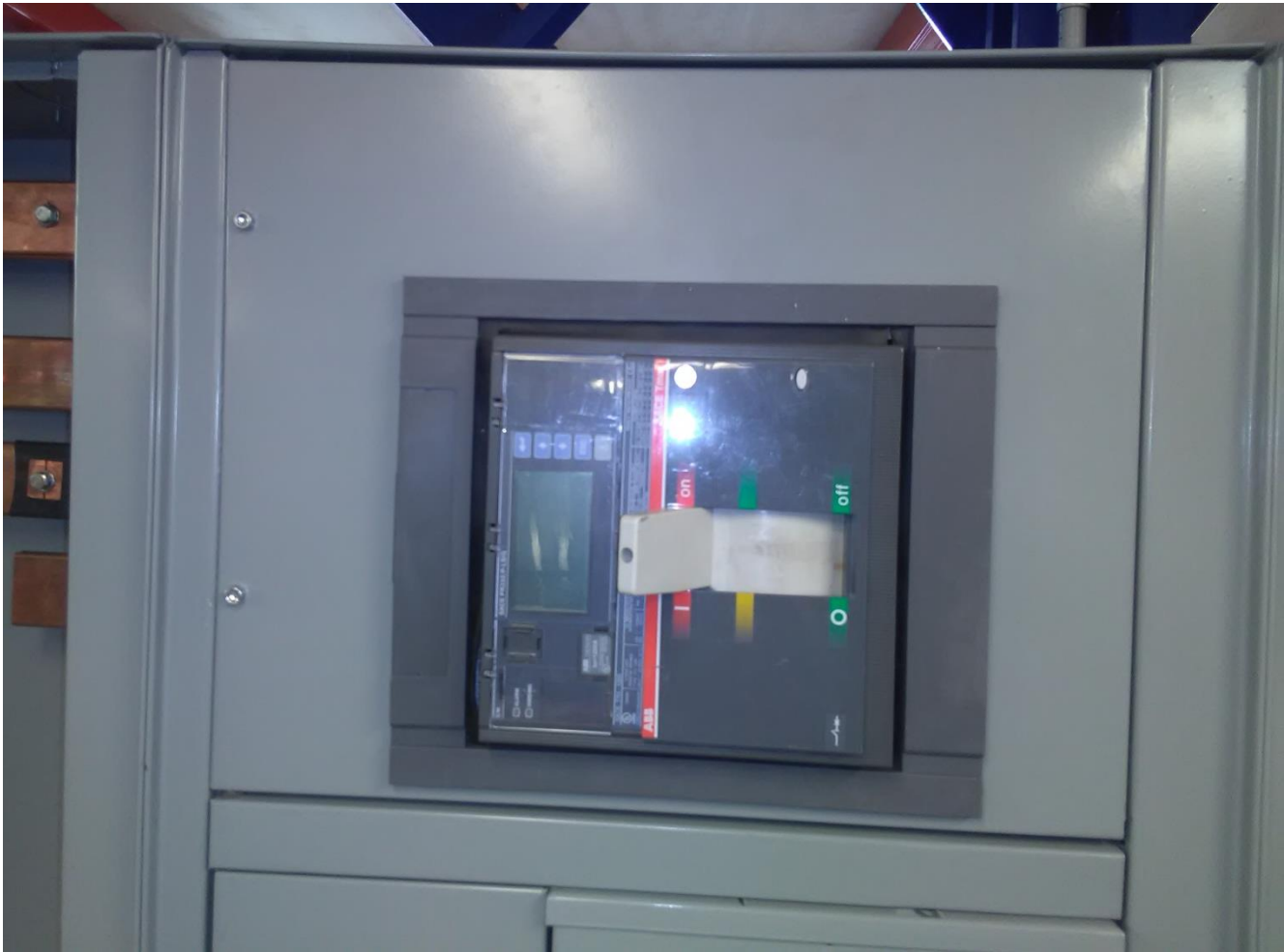
Fig. 7.23 Panel del interruptor principal T7 con bisagras preformadas y dos puntos de fijación mediante tornillo.
