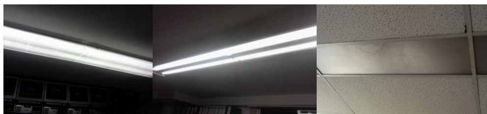
Figura 9. Equipos de iluminación existentes en el inmueble
