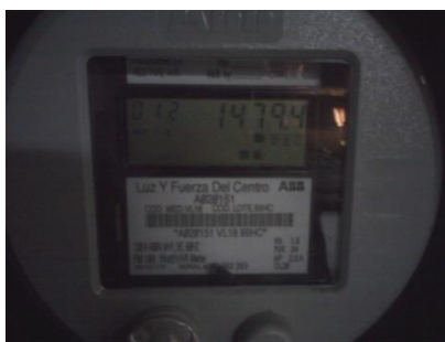
Figura 5. Medidor de consumo de energía eléctrica
