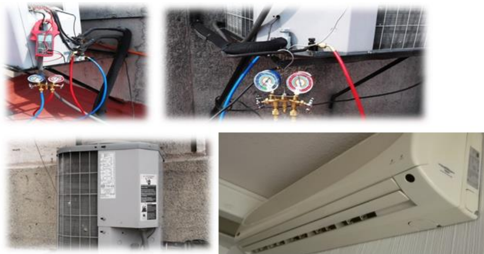
Figura 14. Medición en equipos de refrigeración
