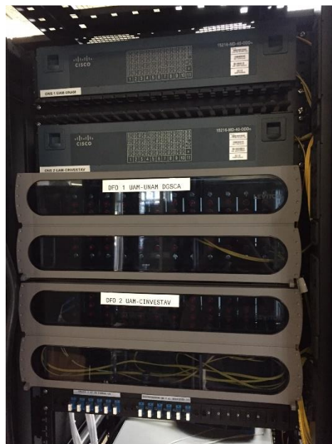
Figura 1.1. Paneles de Distribución de Fibra Óptica.
