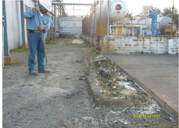
Fotografía 14. Muestreo de suelo en el sondeo STD-1. Evidencia de derrames
