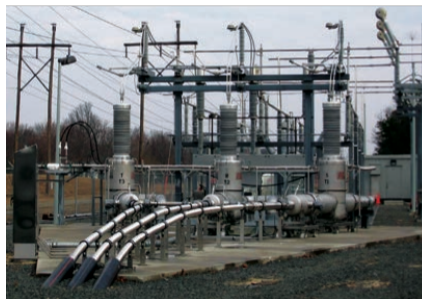
Fig. 2.28 Cables de potencia con superconductores enfriados con helio
