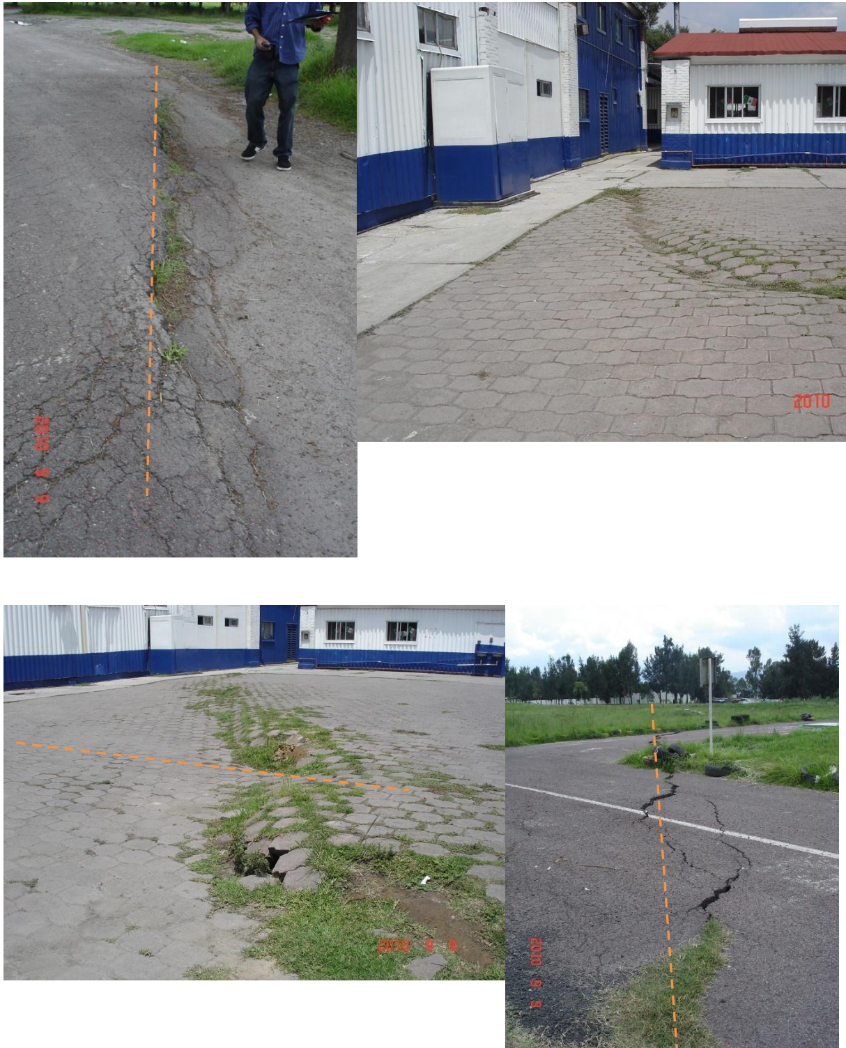
Figura 3.16. Afectaciones en las instalaciones del Agrupamiento Fuerza de Tarea. Se verifica la presencia de escalones; algunos han sido rellenados con asfalto para paso vehicular.
