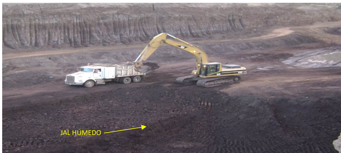
Figura 29 Se muestra el corte que lleva la excavadora sin exponer al camión al jal húmedo.
