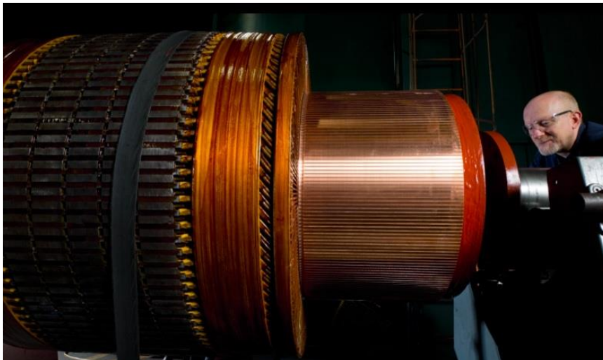
Figura 2.3.6 Bobinado del Rotor del generador. [9]
