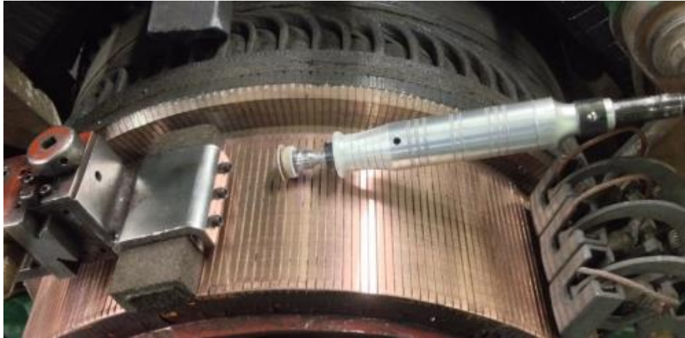
Figura 2.3.9 Porta escobillas del generador. [12]
