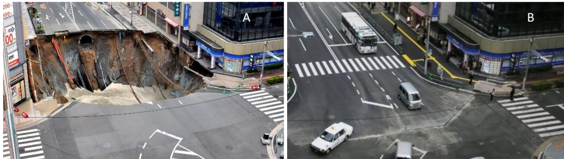
Figura 6. A) Socavón en una de las avenidas de Fukuoka, Japón. B) Reparación del socavón, dos días después del suceso. Fuente: www.bbc.com
